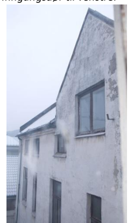
Gjenmuring over vindu viser at arken har hatt høyere vindu tidligere.
