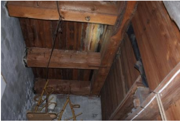
Umalt treverk i himling og på vegg mot do. Slemmet mur.
