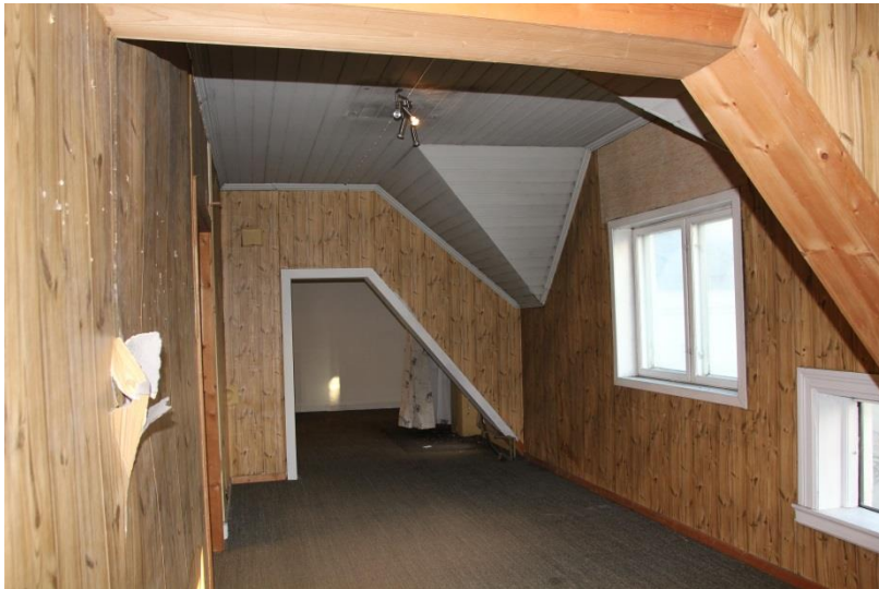
Sett mot rom 3. På et tidspunkt er det blitt satt inn et lavere vindu ved siden av vinduet midt på bakgårdsfasaden. Videre er midtvinduet blitt erstattet av et nyere vindu som ikke er like høyt som det opprinnelige var. Gjenpanelt over vindu.
