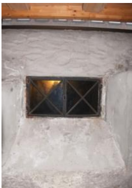
Belysning i kjellervegg.
