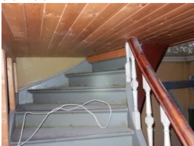
Nyere dekke stenger trapp til 2.etasje. Foto: Siv Leden, NIKU 2015.
