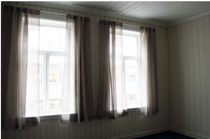
De to vinduene mot gate har T-post.
