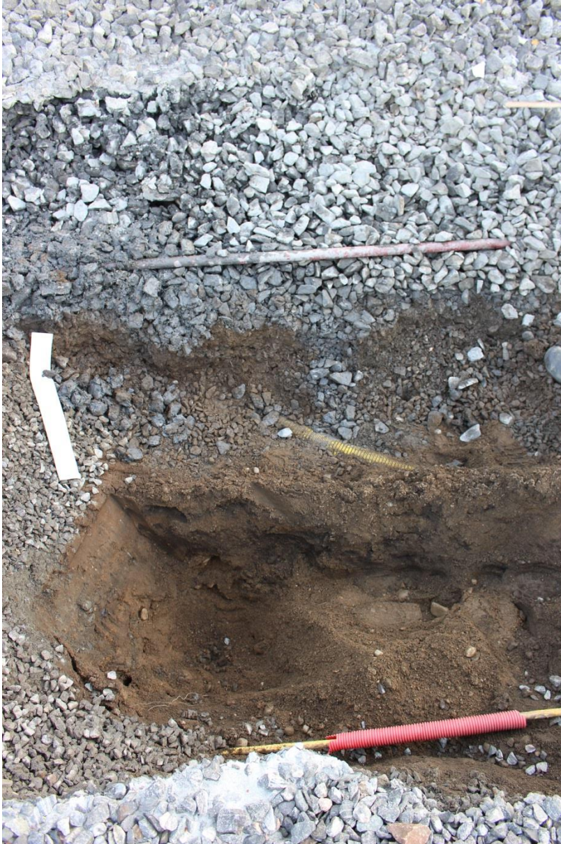
Figur 10: Sjakt ved punkt 5. Øverst sees fiberkabel, og under denne én kabel på hver side av sjakta. Foto: niku_ark_337874.
