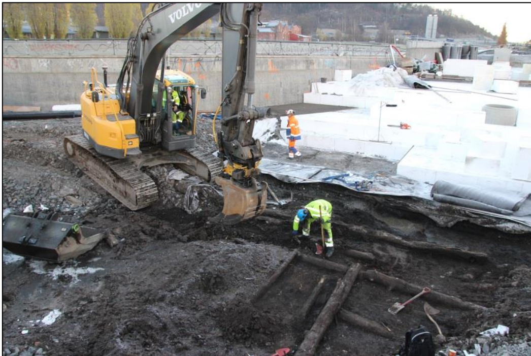
Foto 2: Gorm Hansen renser frem toppen av trekonstruksjonene. I bakgrunnen lettfundamentering for Kong Håkon 5s gate. Sett mot sørøst.
