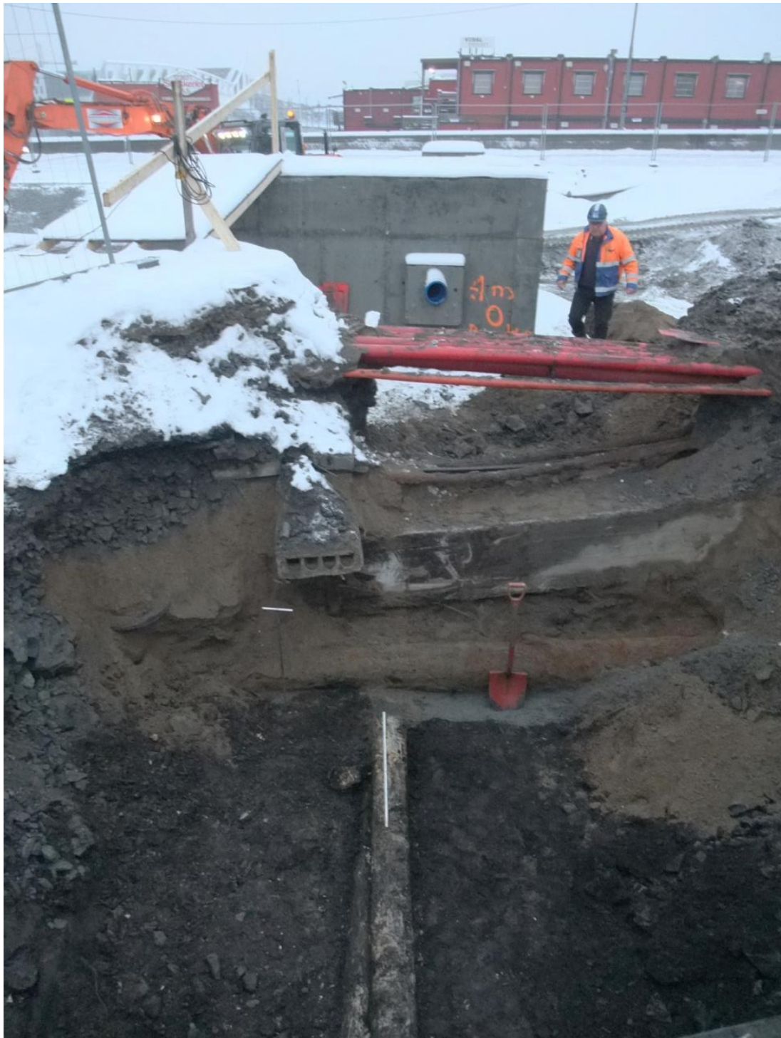
Foto 22: Stokker med påle inntil vestsiden. Spaden står inntil kryssende vannledning. Foto mot nord
