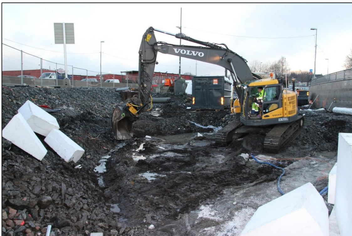
Foto 1: Stort vanntilsig førte til at entreprenøren kom med forespørsel om få grave dypere enn +1moh (som det på forhånd var søkt om) i del 1.
