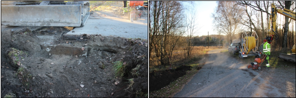
Over til venstre: Bunkersen ligger like under asfalten. Over til høyre: Grøfta blir lagt kant i kant med bunkersen.
