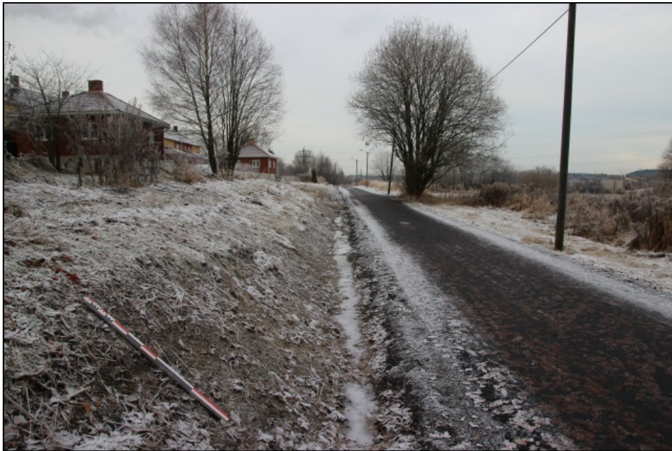
Gravaktivitet rett vest for gangvegen, grøftingen for fiberkabel ble lagt rett nord for gangvegen.
