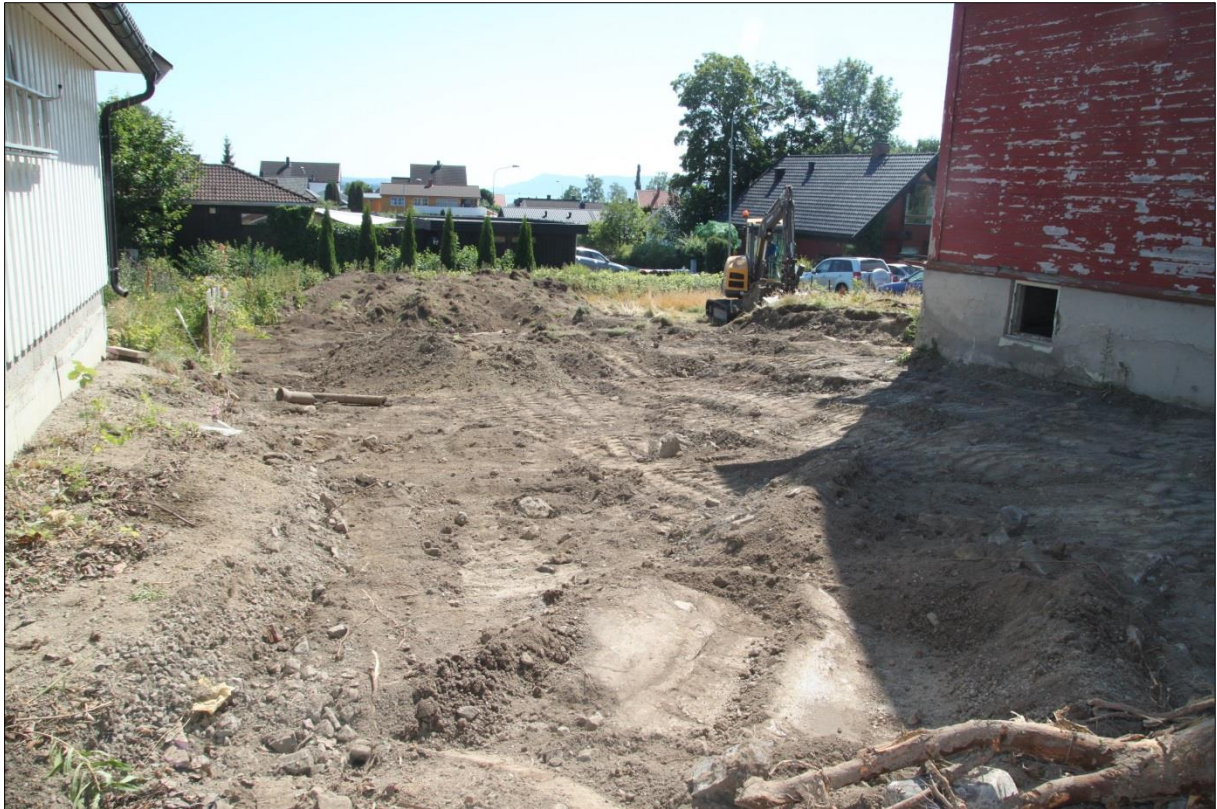
Figur 5 Avdekket areal fra planlagt garasjetomt og sørover i tomtas østre del. Mot S. Foto-nr: Cf53528_NIKU_0014
