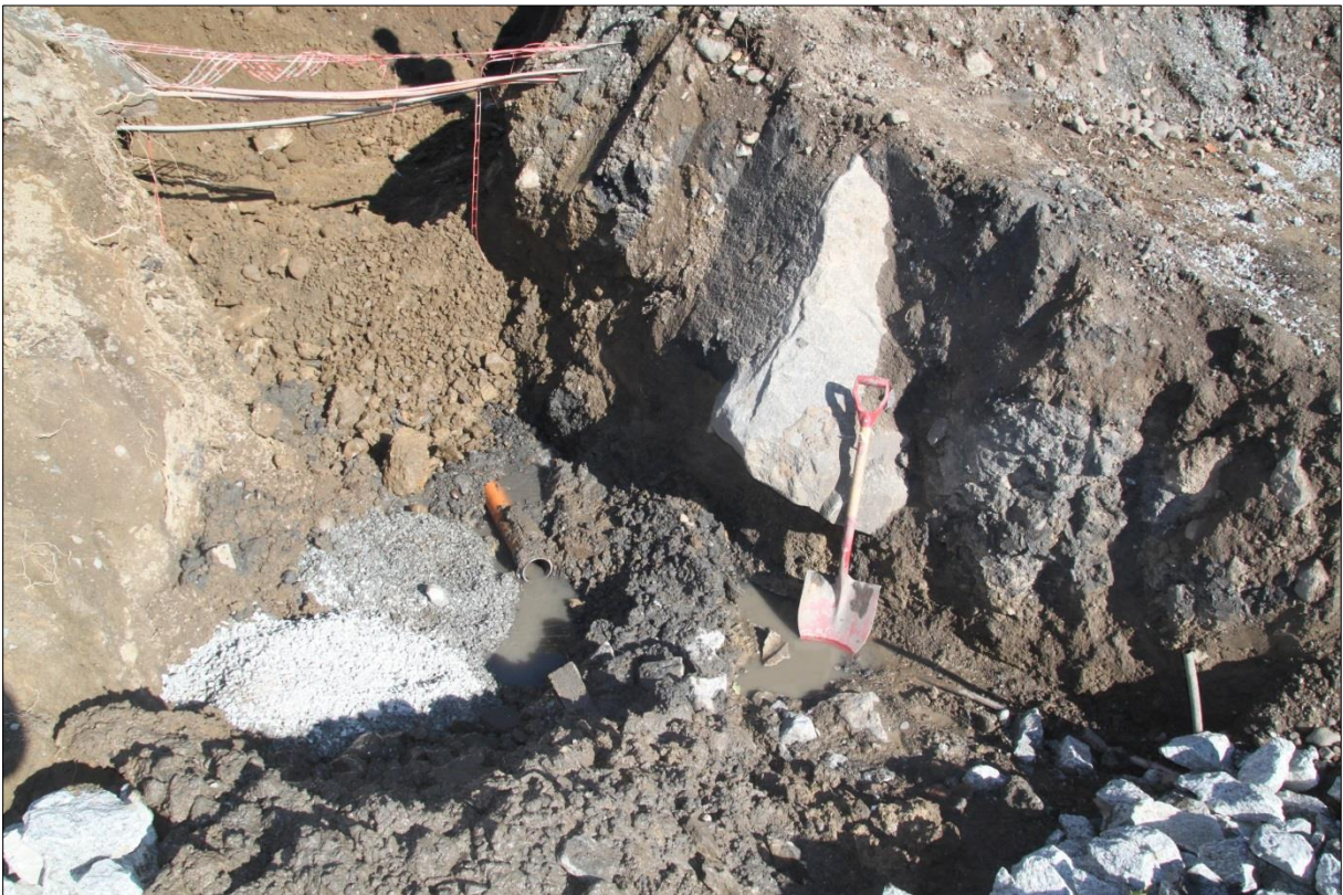
Figur 10 Rør for vann og kloakk ved gammel septiktank samt kabler i bakgrunnen i VA-grøft. Foto-nr: Cf53528_NIKU_0025
