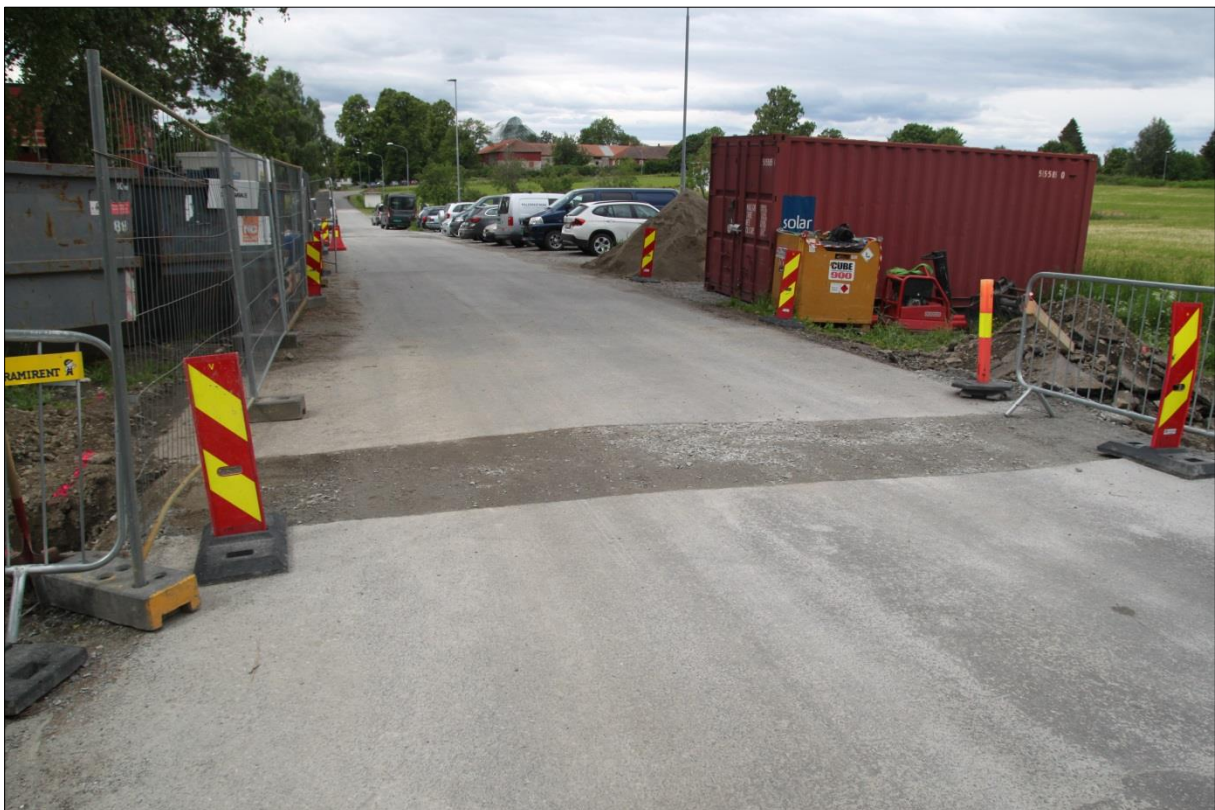
Figur 35: Ø-grøft: strekket over Storhamargata (ferdig gravd og gjenfylt). Mot V. Foto-nr: Cf53321_NIKU_0129
