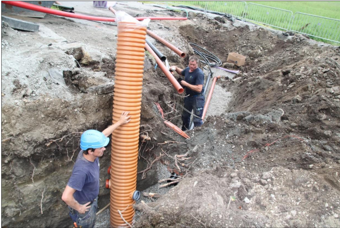
Figur 27: V-grøft, midtre del: div. generasjoner kabler avdekket. Nordre del i bakkant. Foto-nr: Cf53321_NIKU_0037
