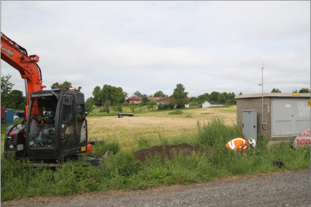
Figur 42: Trafogrøft oversikt: NRK-tomta og Domkirkeodden/Hedmarksmuseet i bakgrunnen. Torfinnsgate og trafostasjon i forgrunnen. Mot V. Foto-nr: Cf53321_NIKU_0107
