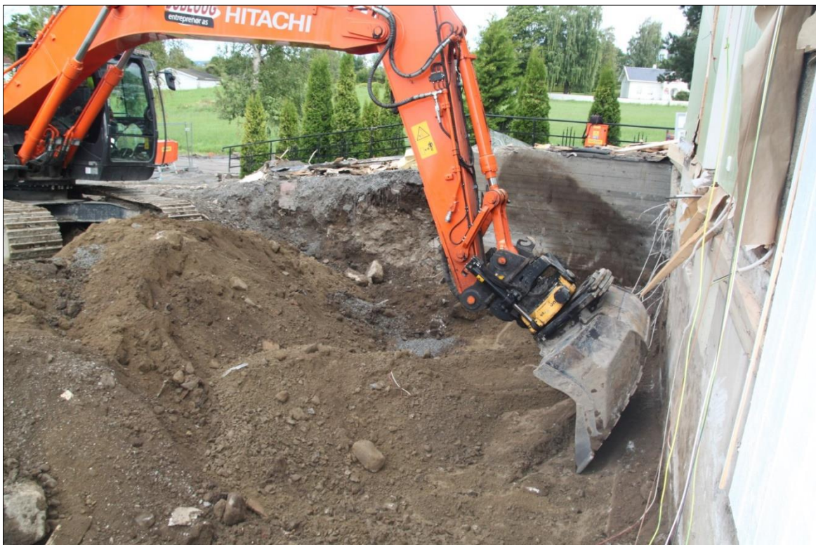
Figur 18: V-tilbygg: detaljfoto av påført gruslag i byggegropa (øvre og midtre lag). Mot N-NV. Foto-nr: Cf53321_NIKU_0044
