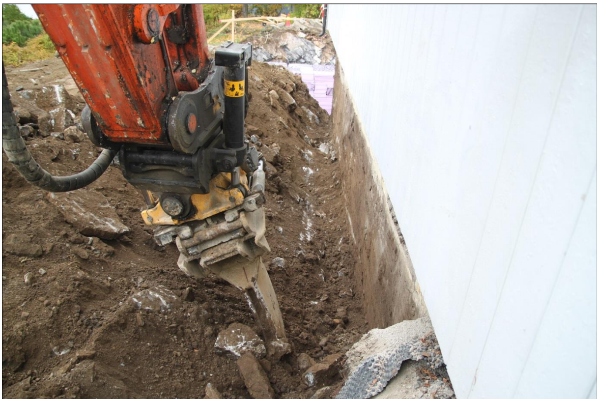
Figur 38: Søndre dreneringsgrøft langs hovedhuset S-side, nærbilde. Mot V. Foto-nr: Cf53321_NIKU_0077
