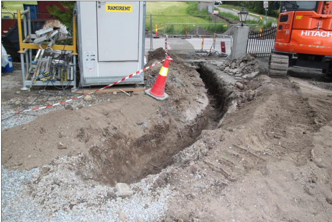
Figur 34: Oversiktsfoto Ø-grøft i sør inkludert strekket over Storhamargata og kobling til Trafogrøfta med kulturlag til trafostasjonen i nord. Mot N-NØ. Foto-nr: Cf53321_NIKU_0134
