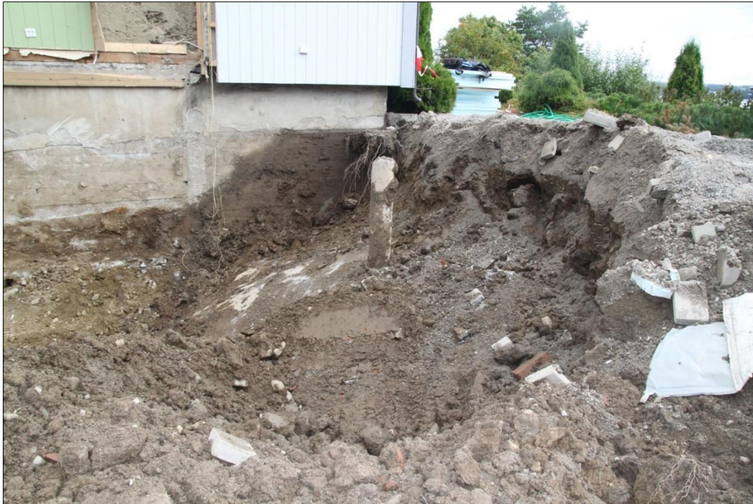
Figur 15: V-tilbygg: fast fjell og gammelt fundamentrør i SØ-del av byggegropa. Mot Ø. Fot Foto-nr: Cf53321_NIKU_0045
