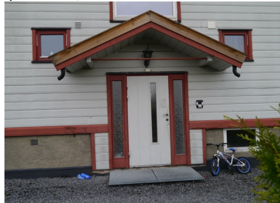
Ole Reistads vei 1, tak over inngang, trolig med opprinnelig bærekonstruksjon. Foto: Siv Leden, NIKU 2016.
