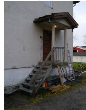
Skårerveien 69. Det eldre inngangspartiet var elegant utformet. Bæringen er kuttet og det henger nå i løse luften. Foto: Siv Leden, NIKU 2016.
