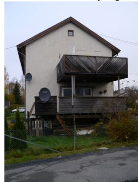
Skårerveien 69. Verandaer på sørsiden er ruvende og dårlig tilpasset bygningen. Foto: Siv Leden, NIKU 2016.
