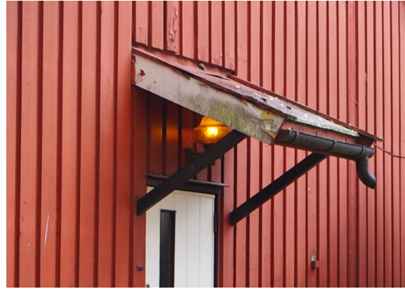
Trygves vei 4, tak over inngang av opprinnelig type. Foto: Bjørn Johansen, NIKU 2016.
