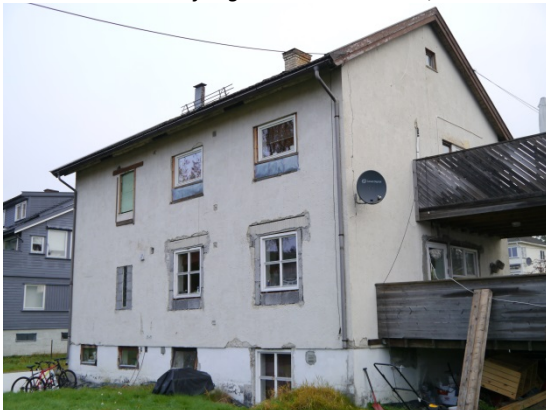
Skårerveien 69. På hagesiden er det satt inn vinduer i ulike formater og størrelser, noe som har svekket bygningens arkitektoniske kvaliteter. Foto: Siv Leden, NIKU 2016.
