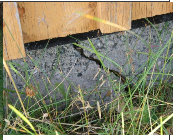
Figur 16: Sprekker i grunnmuren på østfasaden nær hjørnet mot syd. Fotograf: AC Flyen/NIKU 2516
