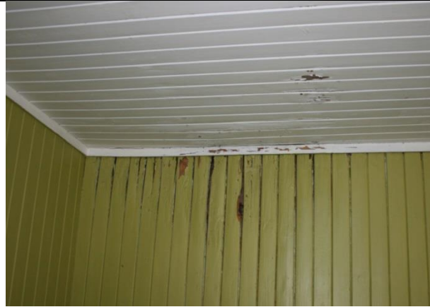
Figur 17: Kraftig råteskade i himlingen og nedover veggen i 1. etasje i stuen på veggen mot syd. Fotograf: AC Flyen/NIKU
