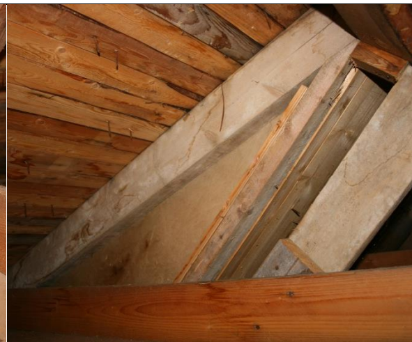
Figur 64: Konstruksjonsdetaljer ved takopplettet. Dette er et svakt punkt der det ofte opptrer skader. Heller ikke her var det synlige skader, bare litt fuktskjolder i undertaket rundt takopplettet. Fotograf: AC Flyen/NIKU
