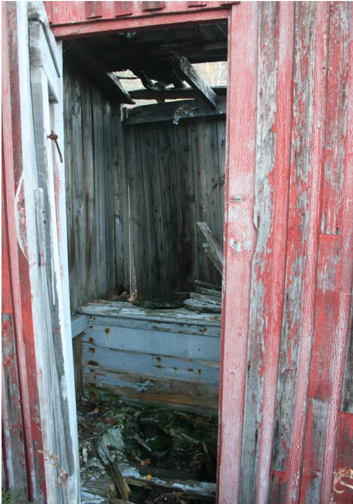
Foto 92: Innvendig er det svært synlig at utedoens konstruksjon er svært nedbrutt av råte. Imidlertid er do-benken relativt intakt. . Fotograf: AC Flyen/NIKU
