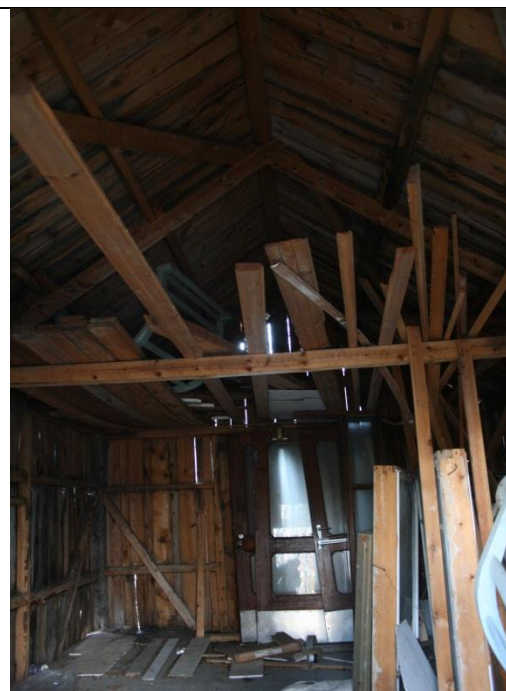
Figur 80: I uthuset oppbevares materialer og bygningsdeler. Dette gjorde det vanskelig å inspisere alle overflater og bygningskonstruksjoner. Fotograf: AC Flyen/NIKU
