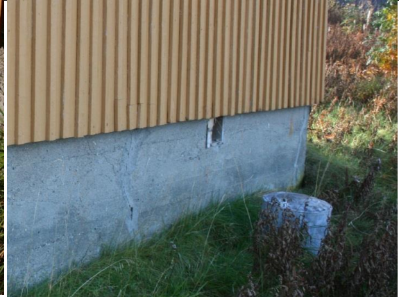
Figur 14: Sprekker i grunnmuren på nordfasaden nær hjørnet mot vest. Disse er tidligere forsøkt tettet igjen med mørtel. Fotograf: AC Flyen/NIKU
