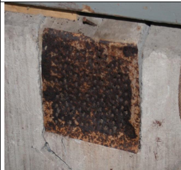
Figur 35: Jernristen foran lufteluken og spiker i kjelleråpningen viser tydelige tegn på stor fuktbelastning. Fotograf: AC Flyen/NIKU
