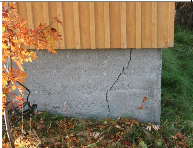
Figur 15: Sprekk i grunnmuren på østfasaden nær hjørnet mot nord. Fotograf: AC Flyen/NIKU 2510
