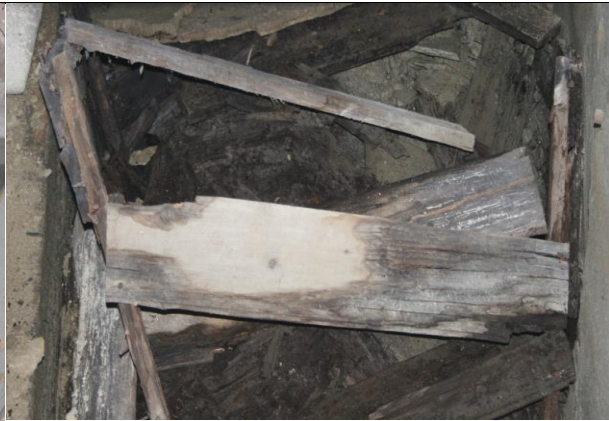
Figur 30: Nedre del av trappen er helt nedbrutt av råte, og restene ligger på kjellergulvet. Fotograf: AC Flyen/NIKU
