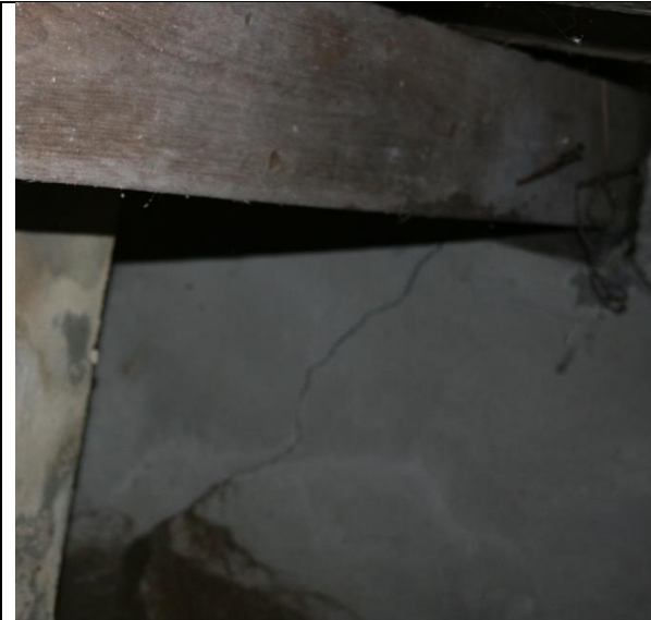
Figur 33: Kjellermuren har en del sprekker Fotograf: AC Flyen/NIKU
