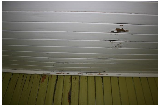
Figur 19: Kraftig råteskade i himlingen og nedover veggen i 1. etasje i stuen på veggen mot syd. Fotograf: AC Flyen/NIKU
