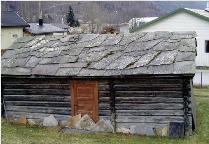
Hus på Otta med sidesua rasteheller. Nedbøren pleier å komme fra venstra mot høyre i bildet og da er taket tett. Foto: Kjell Andresen © Riksantikvaren
