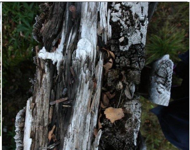
Figur 73: Øvre del av veggen er sterkt nedbrutt av råte: AC Flyen/NIKU
