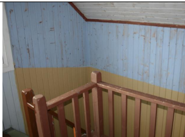
Figur 47: Veggene i trapperommet har malt faspanel av typen geyfus. Øvre del av vegg i trappeløp har fortsatt original maling. Fotograf: AC Flyen/NIKU
