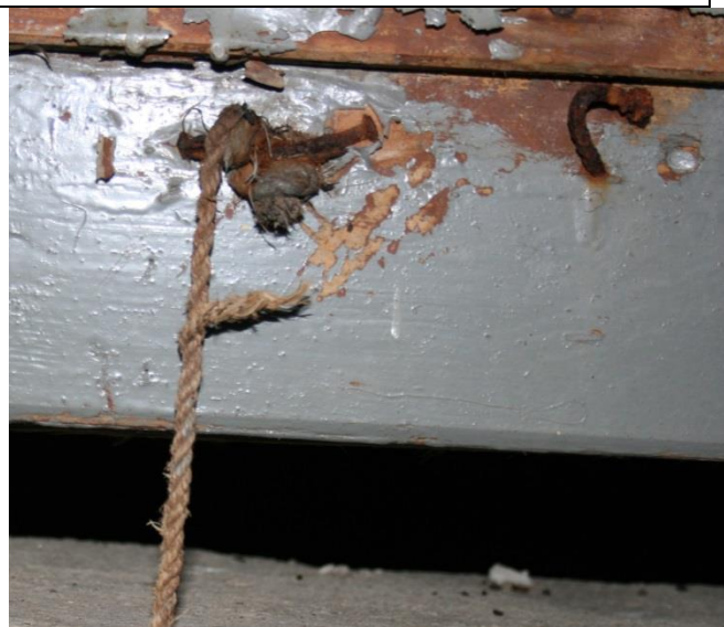
Figur 36: Jernristen foran lufteluken og spiker i kjelleråpningen viser tydelige tegn på stor fuktbelastning. Fotograf: AC Flyen/NIKU
