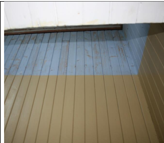
Figur 39: Øvre del av vegg i trappeløp har fortsatt original maling. Fotograf: AC Flyen/NIKU
