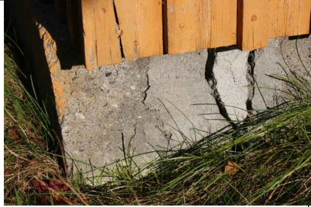
Figur 13: Sprekk i grunnmuren på sydfasaden like ved hjørnet mot vest. Fotograf: AC Flyen/NIKU
