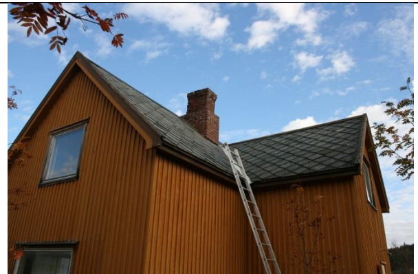
Figur 20: Råteskaden er ikke synlig fra utsiden ettersom den ligger inne på «blindloftet» og ikke ut i ytterveggen.. Fotograf: AC Flyen/NIKU
