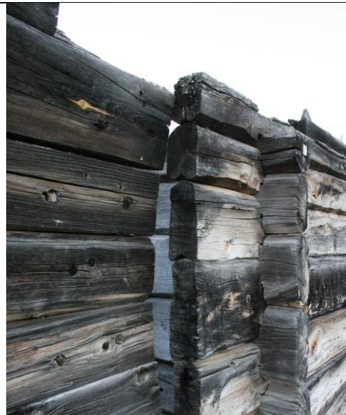
Figur 100: Det er også dårlige sammenføyninger mellom tømmerkonstruksjonen og delen av flyplassplank. Fotograf: AC Flyen/NIKU
