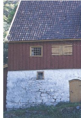
Denne grunnmuren er hvitkalket og må fortsatt hvittes med kalk! Plastmaling vil skape bære vedlikeholdsmessige og bygningstekniske problemer.
