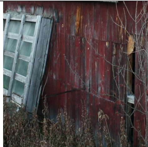
Figur 87: Det er tydelige råteskader i nedkant av panelet på alle fasader, her i sydveggen. Fotograf: AC Flyen/NIKU
