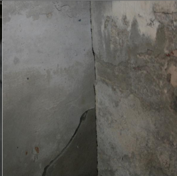
Figur 34: Kjellermuren har en del sprekker Fotograf: AC Flyen/NIKU
