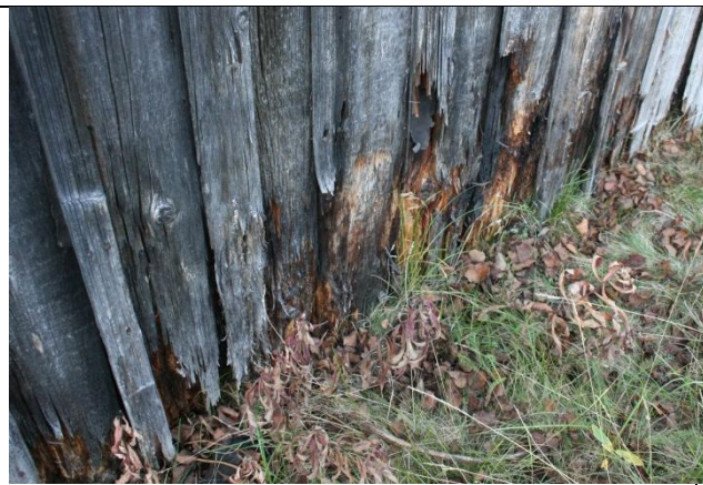
Figur 72: Panelet har kraftige råteskader i nedre del. Her på vestveggen. Fotograf: AC Flyen/NIKU
