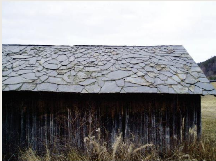
Villhelletak fra Ringebu. Villhelletakene i Gudbrandsdalen er de tetteste og best lagte i landet. Foto: Kjell Andresen © Hordaland fylkeskommune
