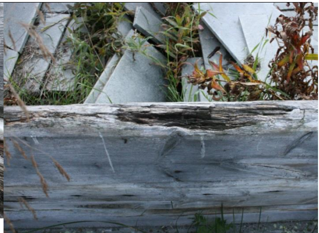
Figur 98: Råteskader i vindusåpning. Fotograf: AC Flyen/NIKU
