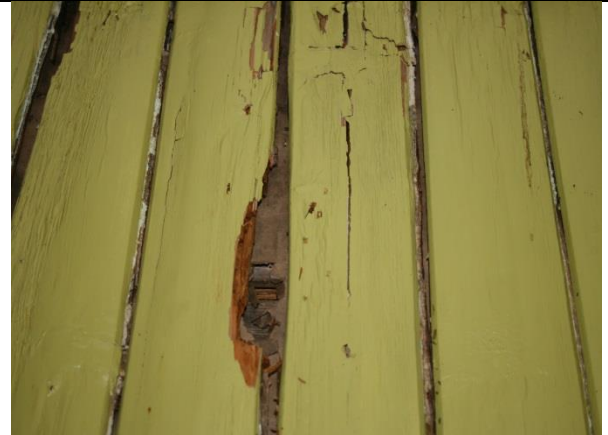
Figur 18: Kraftig råteskade i himlingen og nedover veggen i 1. etasje i stuen på veggen mot syd. Fotograf: AC Flyen/NIKU
