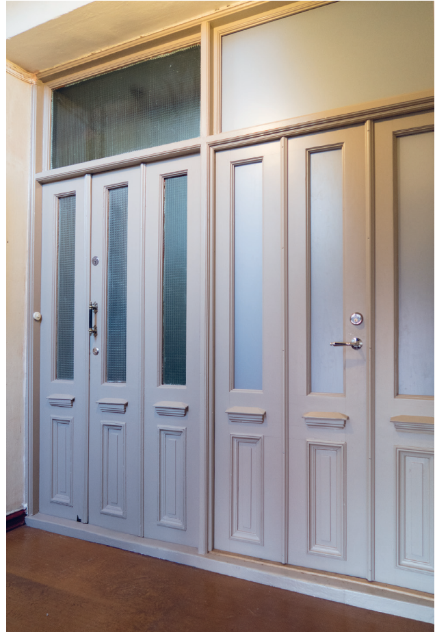
Figur 2.1: Eksempel på oppgradering av trapperomsdør etter Oslo kommunes veileder, sett fra trapperommet. Dør til høyre er utbedret med brannhemmende maling på alt treverk på begge sider og brannsikre glass med folie påklebet på utsiden for å hindre innsyn. Dør til venstre er ikke utbedret da det er laget en sluse med ny dør på innsiden. Foto: Barbro Wedvik NIKU, 2017.
