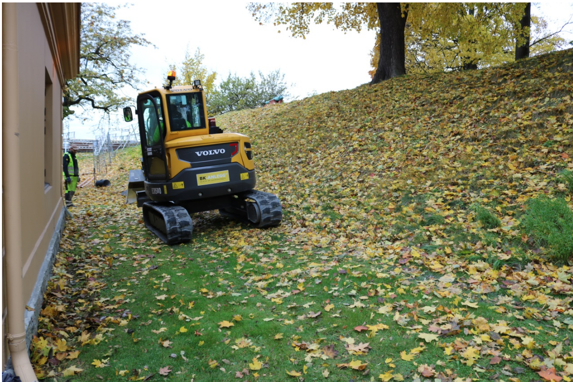
Figur 1: Området langs den nordre vegg til Corps du Garde før oppstart av sjaktingen. Foto-nr: Cf35158_NIKU_0001.
