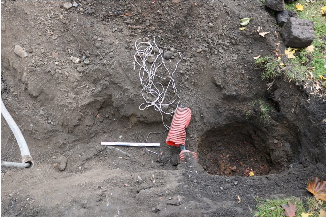
Figur 4: Sjakten ved det nordøstre hushjørnet av Corps du Garde hvor det skal etableres en kum med rist. Foto-nr: Cf35158_NIKU_0015.
