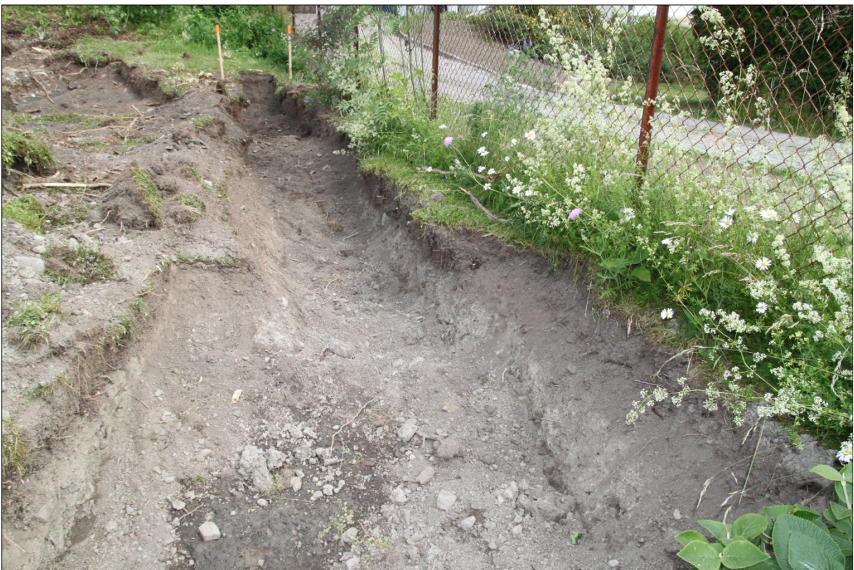
Figur 25 Oversiktsfoto søndre del av sjakt 4 (tangerer nordre del av Sjakt 5 i forgrunnen), tiltak 2 – ny hekk langs østre grense. Mot N. Foto: NIKU Cf35137_0088.
