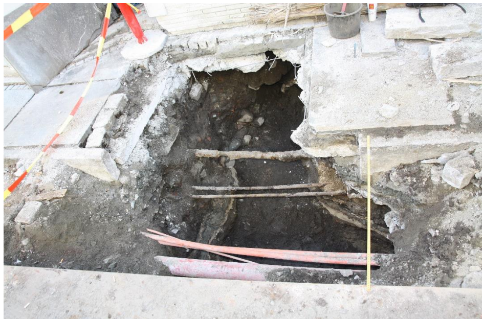
Figur 1. Oppgravd område ved Hollendergaten 3. Vinkelrett ut fra grunnmur i bygningen ble et eldre vannrør skiftet. I gateløp og fortau lå en rekke kabler og rør, med vannledning lengst øst i graveområdet. Foto tatt mot vest-sørvest, Bf30013_NIKU_0012.JPG
