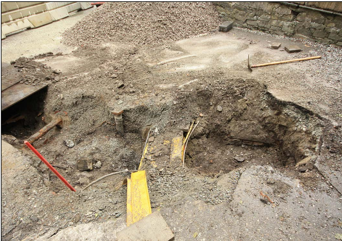
Figur 6. Grøften i strekningen opp mot porten til parkeringsplassen. (Bilde nr. Bf30010_NIKU_0034; Dunlop, NIKU)
