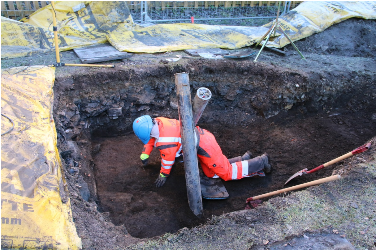
Figur 4: Brønn 2+3. Tilstedeværelsen av brønnrørene var tidvis svært upraktisk i forhold til feltarbeidet. Sett mot S. Foto-nr: Cf35149_NIKU_0017
