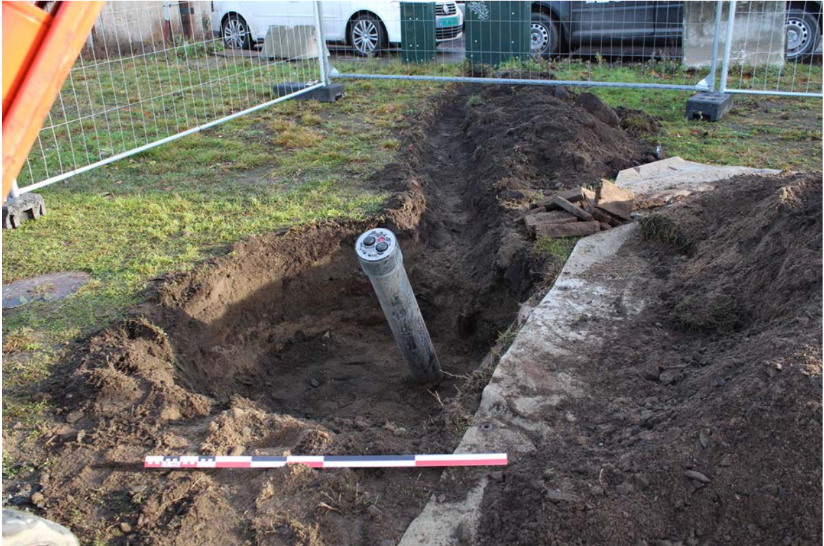
Figur 62: Brønn 4. Ferdig gravd grop til kum og grøft. Sett mot Ø. Foto-nr: Cf35149_NIKU_0732
