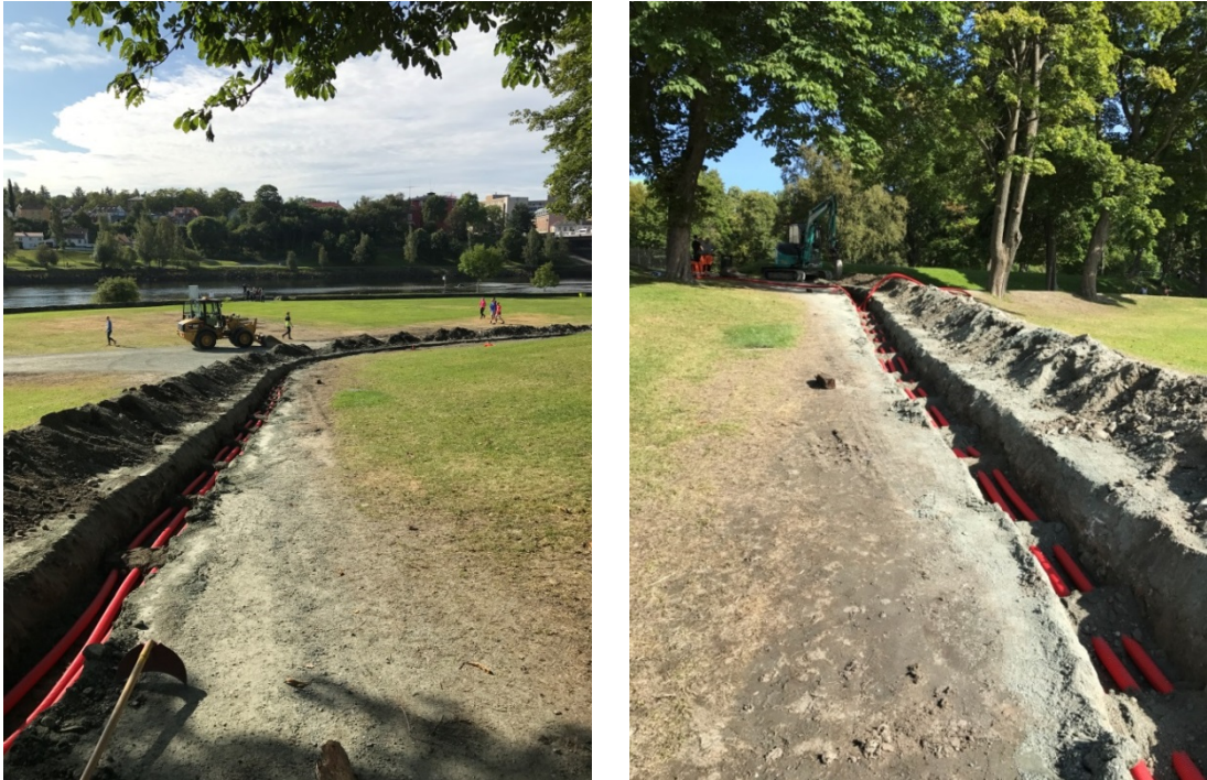
Figur 49: Oversikt sjakt mot lysmastgrop 22, mot S (venstre) og oversikt sjakt mot lysmastgrop 30, mot nord (høyre).
