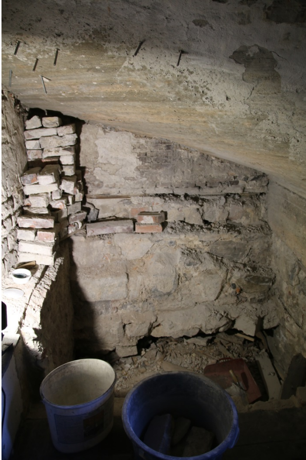
Figur 3: Arbeidsbilde. Bøttene står på nåværende gulv, og det var en avsats ned til der hvor løsmassene skulle fjernes. Sett mot vest. Foto-nr: Cf53291_NIKU_0002
