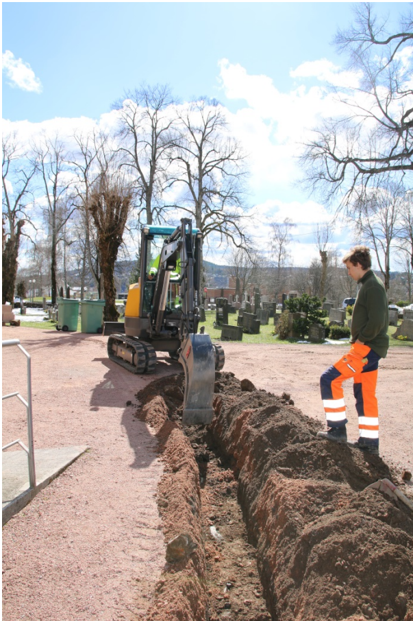
Figur 7: Arbeidsbilde graving av grøft på vestsiden av kirken. Sett mot sørvest. Foto-nr: Cf53289_NIKU_0033
