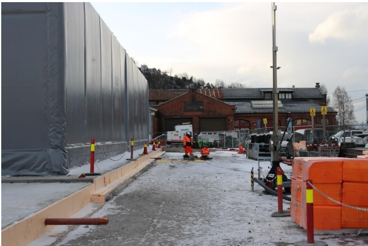
Figur 3: Oppmerking i tiltaksområdet, sett mot S. Nylig oppsatt telt for maskinvedlikehold er til venstre i bildet. Foto: Cf53280_NIKU_0001.
