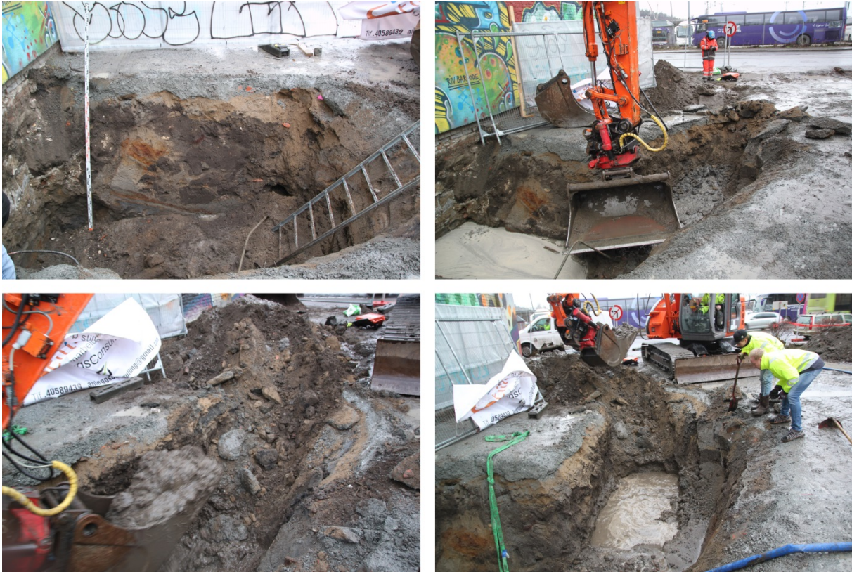
Figur 7 Brudd på vannledning i grop 2. Øverst, tv: Grop 2, sett mot sør. Vannledningen (nederst til høyre i gropen) har akkurat revnet, og vann begynner å renne ut. Øverst, th: Graving av nødgrøft. Vannstanden steg raskt langs kjellermuren av Schweigaardsgate 48. Nederst, tv: Nødgrøft. Merk store steiner som kommer opp fra fyllet i grøfta, muligens også sidekantene. Nederst, th: Fullt omfang av nødgrøft. To pumper måtte til for å senke vannstanden. Beredskapstropp fra Vann- og avløpsetaten synlig gjennom vindu i hvit bil i bakgrunnen.
