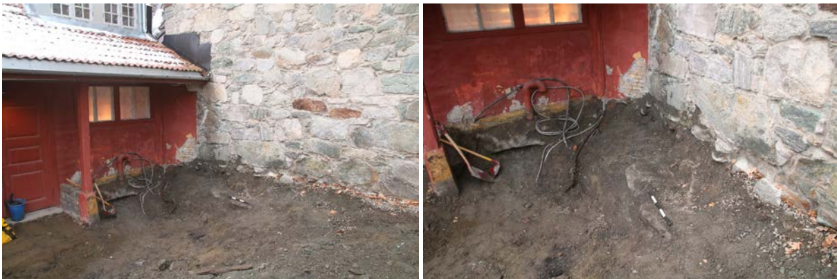
Venstre: Situasjon etter graving inntil hjørnet Artilleribygget/Feltartillerifløyen →SV. Høyre: Kulturlag og steinene til høyre, kabelgrøften til venstre →SSV. Da60268_0012 & Da60268_0013
