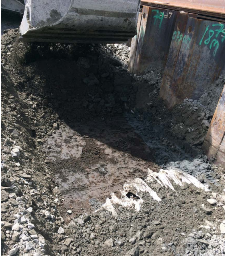
Figur 6: Pukk og veiduk måtte graves igjennom. Sett mot sørvest. Foto nr: Cf53513_NIKU_35.
