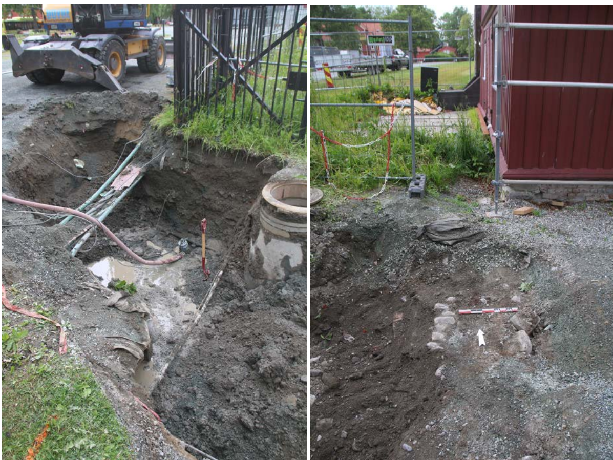
Fig. 3. Venstre: Hullets vestre halvdel med avdekkete kabeltraseer, vannrør og fjernvarme (dekket med duk i forgrunnen), sett mot NV (Da 60275_006). Høyre: Hullets østre kant med steinbrolegning på rasleira og Artilleribyget i bakgrunn, sett mot N (Da 60275_010).
