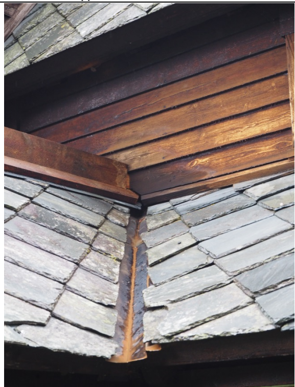
Gradrenne på svalgang sør for koret. Gradrennene bør være lengre/ ha en dryppnese lenger unna taket, slik at vannet slippes ned lenger unna bygningen.
