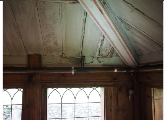
Flere steder i svalgangen var det spor i limfargen etter gjentatt vanninntrengning. Det sees som mørke skjolder i farge, slik som på dette bildet,
