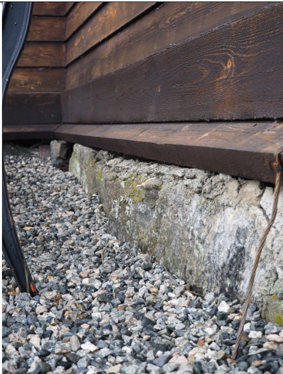
Svalgang, rett sør for inngang i vest. Grunnmuren er delvis pusset med sementholdig mørtel. Setninger gjør at pussen slipper fra vannbordet og åpner for at vann renner inn.
