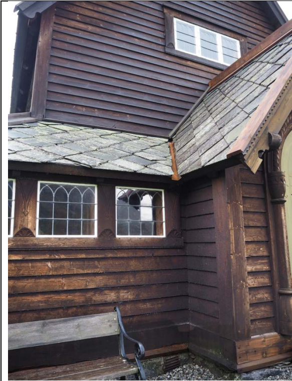
Inngangsparti i vest. Legg merke til fuktig vegg, vannbord og sokkel.
