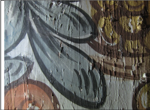
Oppskallinger og avskallinger i limfargedekoren i skipet, vestre del av nordvegg
