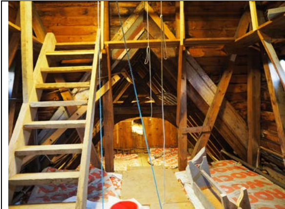
Hele bjelkelaget mot loft er isolert med mineralull (stein). Her fotografert fra tårnkonstruksjonen.
