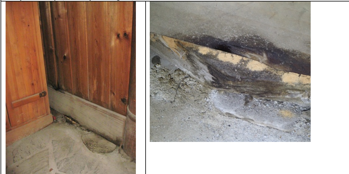
På innsida av nordre omgangens østre hjørne ble det registrert boremel, se detaljbilde til venstre, og tegn på fuktbelastning.
