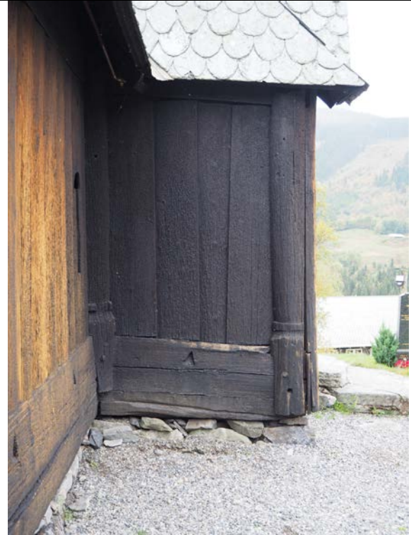
Stavkonstruksjon i inngangsparti i vest bør overvåkes.
