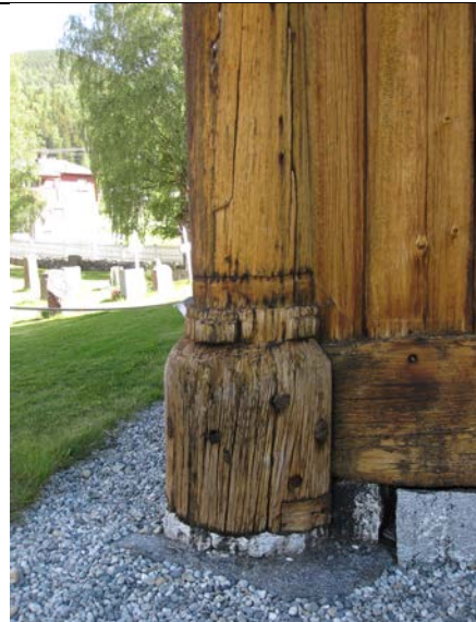
Vestvegg stav mot nord, base, slitt av vann og vær, men plassert opp fra bakken
