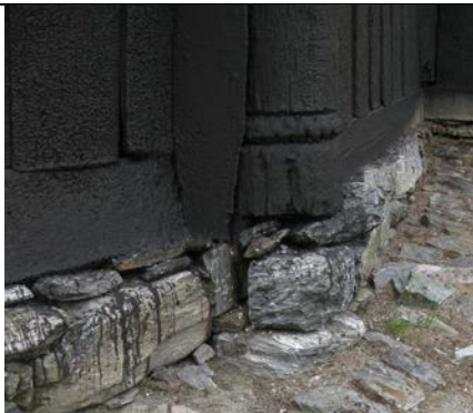
Stav på overgang korvegg-apsis nordside.
