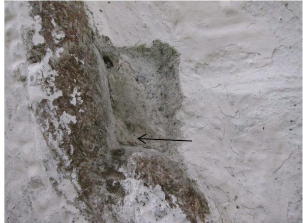
Figur 11: Avdekning ved portalens nordre dragehale. Opprinnelig puss ligger helt inntil den huggete dragehalen. Foto: NIKU 2016.
