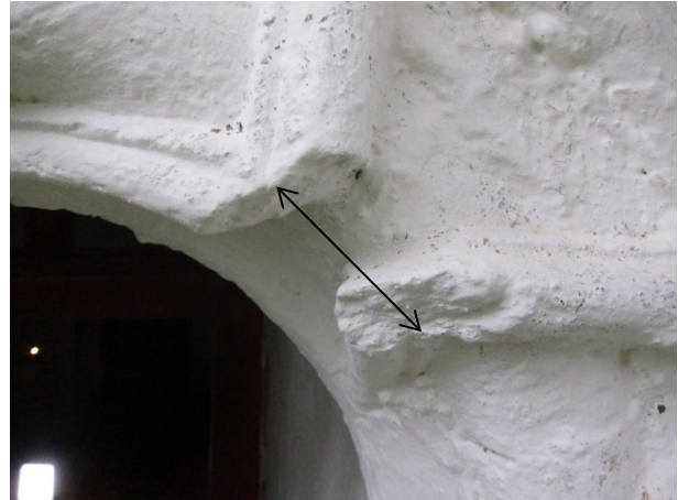
Figur 5: Detalj av vestportalen. Deler av chevron mangler (pil). Foto: NIKU 2016
