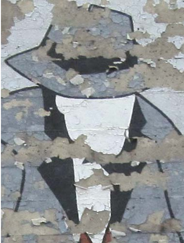
Figur 16: Detalj av motivet ved utgåendeperrong, vendt ut av byen før rehabilitering. Malingen hadde løsnet i store flak helt ned til underlaget.
