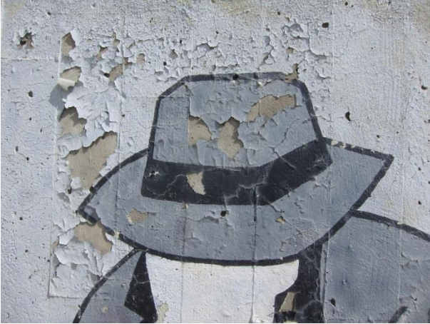
Figur 26: Detalj av opprinnelig motivet ved utgående perrong, vendt mot sentrum, før rehabilitering. Opp- og avskallinger i maling ned til betong.
