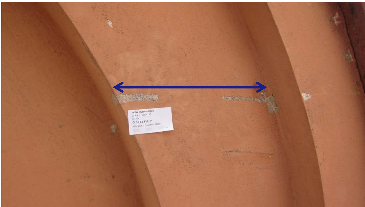
Figur 3: Detalj fra gavlfeltet med (fra venstre): indre felt, indre ramme og ytre ramme. Det er funnet blå kun på den indre rammens forside, merket med blå pil. De resterende flater var malt lysegrå. Foto: NIKU 2016
