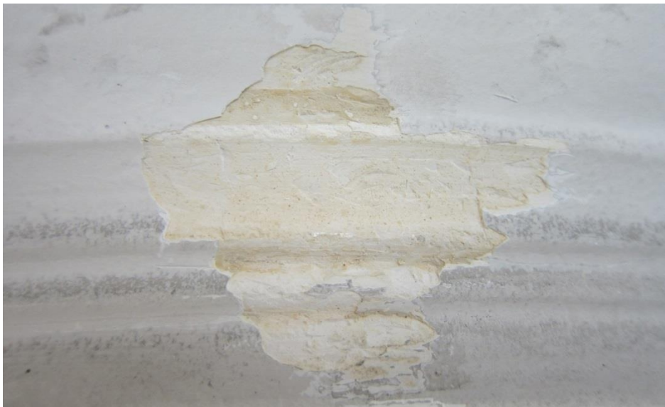
Figur 16 Rom 114. Himling. Avdekking av malingslag på stukkatur/profilert pålimt list.
