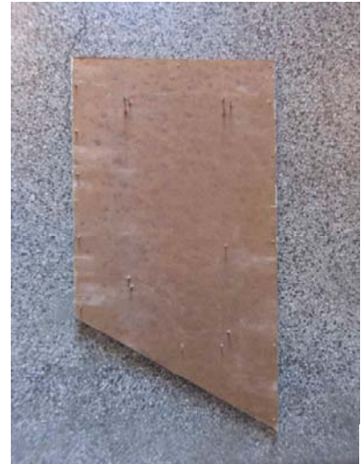
Baksiden av fiberplaten som ble fjernet fra brytningdelen som vist i venstre bilde.
