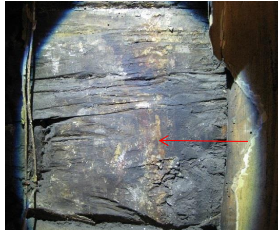
Rester av samme dekor funnet syd for vinduet på vestveggen. Dekoren ble senere dekket av gul limfarge og skitt.
