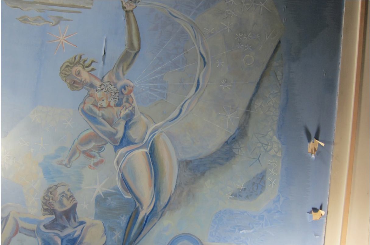
Figur 1 Detalj av takmaleriet før behandling. Maleriet hadde store av- og oppskallinger og delvis oppsprukne lommer i malingen.
