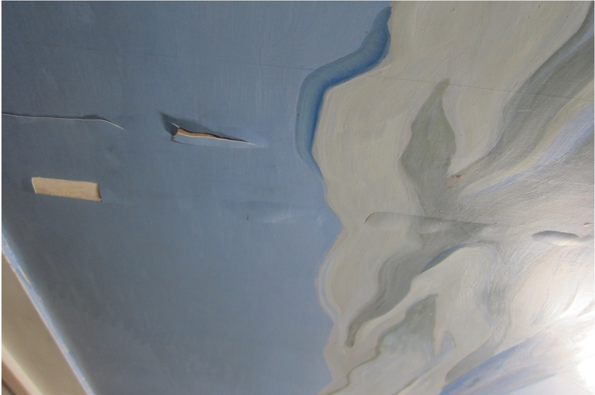
Figur 5 Detalj av av- og oppskallende maling, samt lommer før behandling
