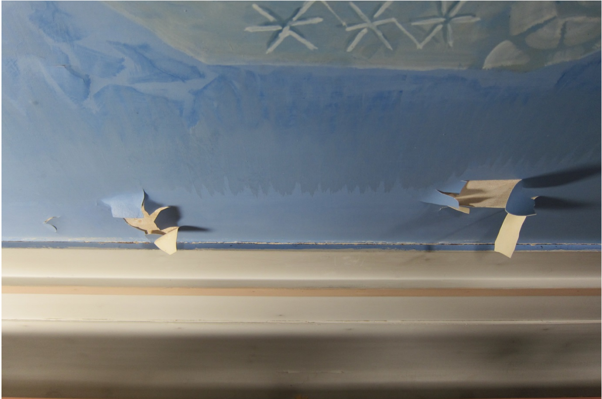
Figur 3 Detalj av oppskallende maling før behandling.
