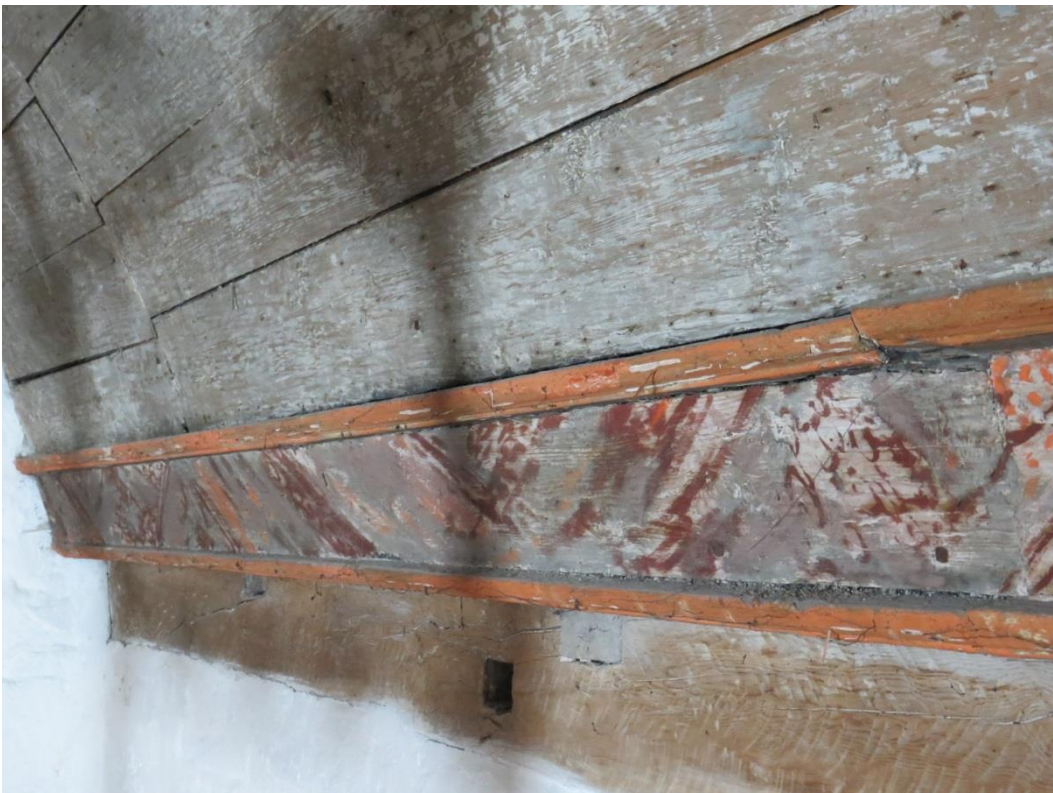
Figur 31 Frise på nordsiden sett mot vest. Rød maling på listverk flaser av. Marmorering har avskallinger og overmaling.
