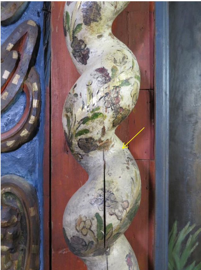
Figur 22 Detalj av nordre søyle i andre etasje halvveis rensset. Nedenfor pilen er det ikke rensset.
