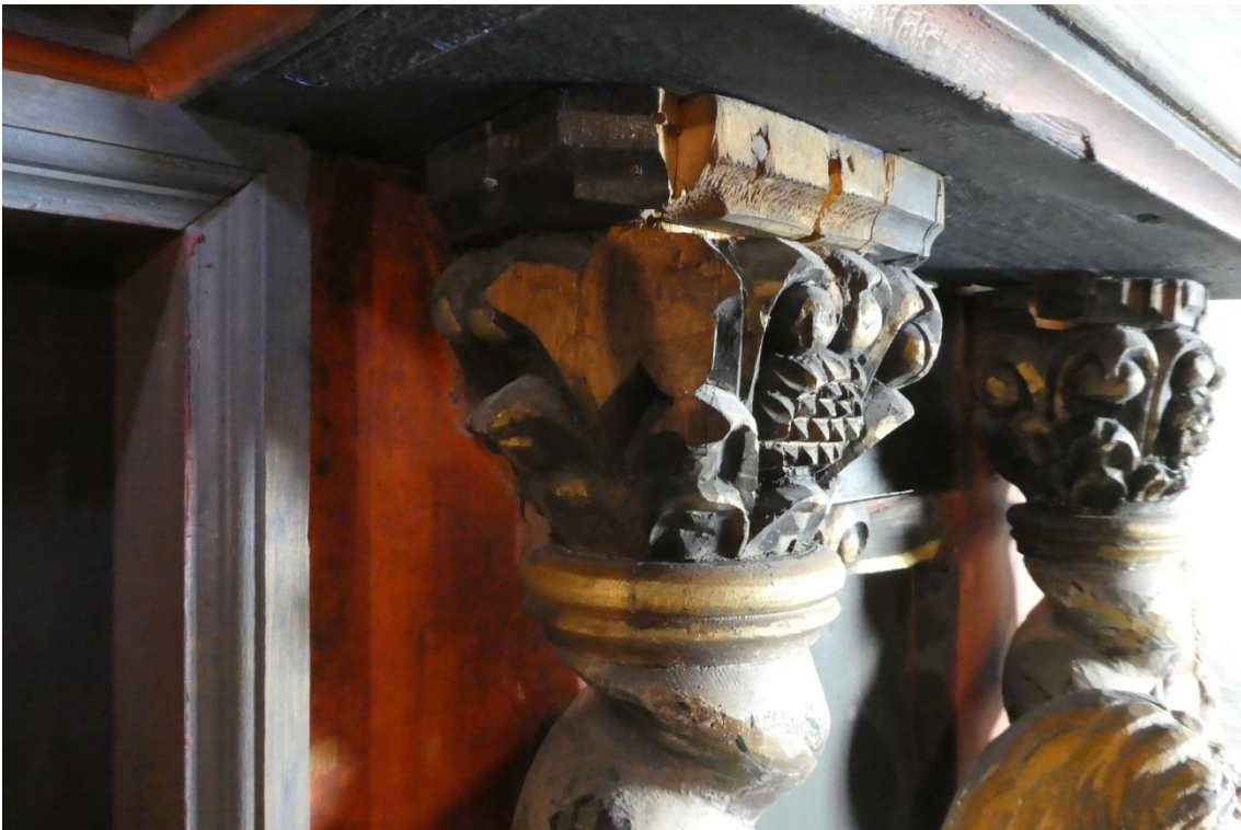
Figur 10 Skader i treverk på innerste kapitel på søndre side i første etasje.
