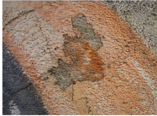
Figur 7: Detalj i vestre veggmaleri. Avskalling. Tilstand før behandling. Foto: NIKU 2107
