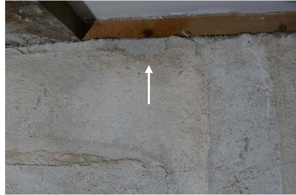
Figur 12: Detalj i østre veggmaleri. Pussreparasjoner (pil). Foto: NIKU 2017
