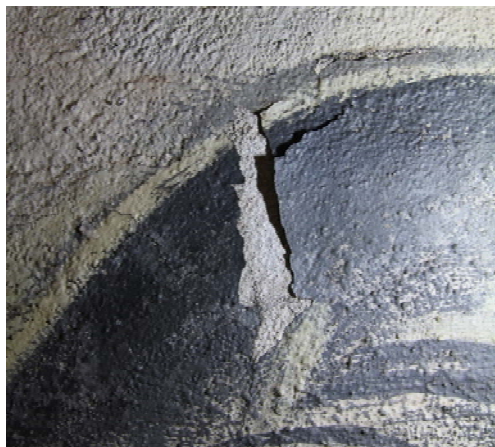
Figur 9: Detalj i østre veggmaleri. Oppskalling. Tilstand før behandling i 2017. Foto: NIKU 2107
