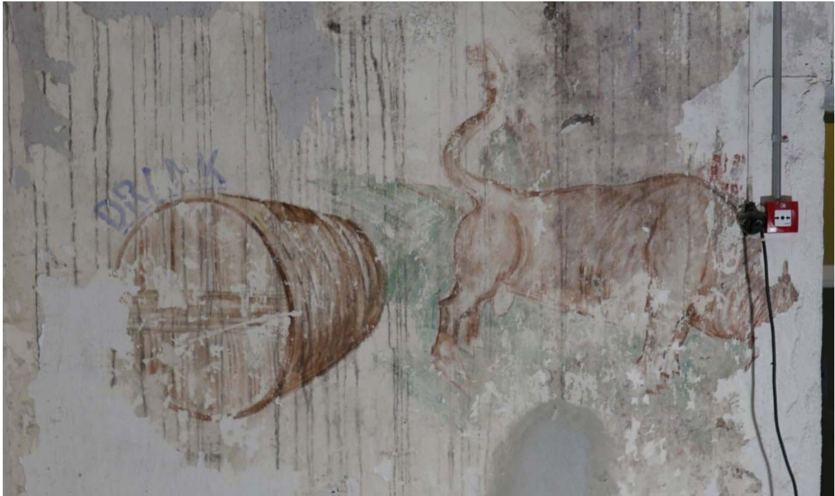
Maltlager. Veggmalierier «Drank». Tilstand før behandling. Foto: NIKU/Kaun 2017
