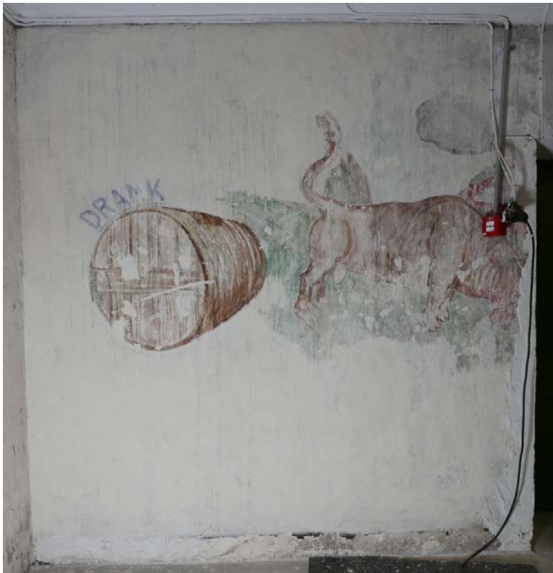
Figur 30: Veggmaleri et «Drank». Tilstand etter avdekninger og grundering av skader og mørke flekker. Vegg rundt motivet er kalket tre ganger, og de skjemmende mørke rennene er blitt mindre synlig. Foto: NIKU 2017
