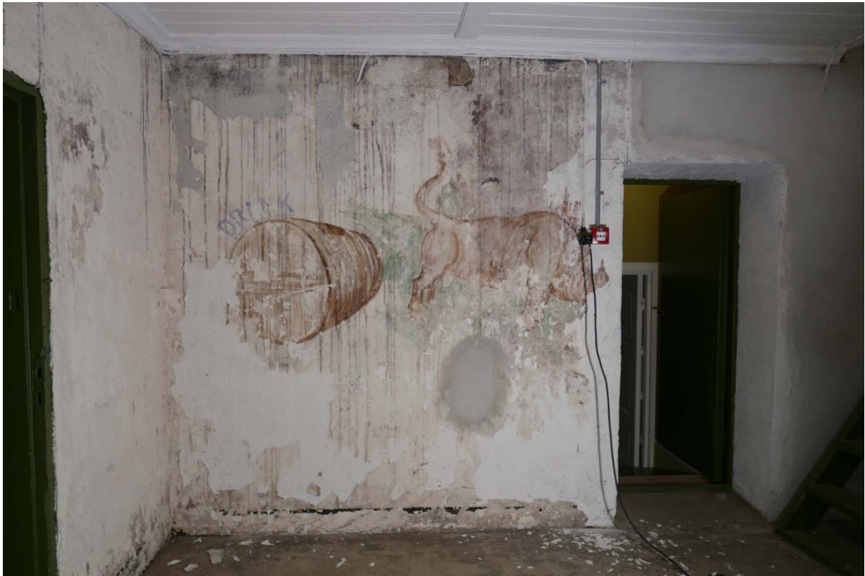
Maltlager. Veggfelt med veggmalерier «Drank». Tilstand før behandling. Foto: NIKU/Kaun 2017
