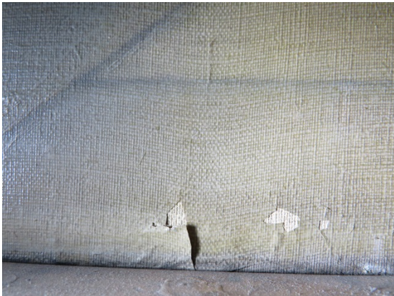
Figur 9a Løs maling, venstre side ned mot rammekant
