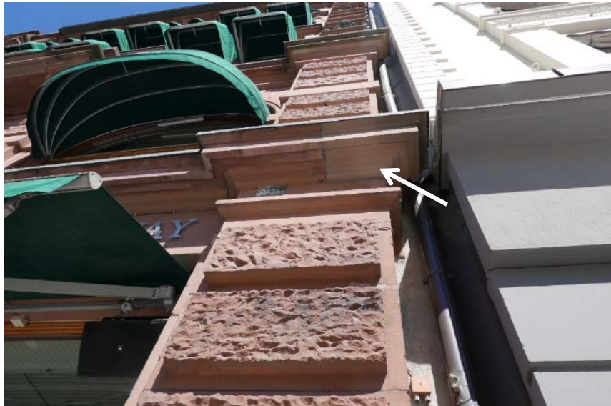
Figur 10: Rød pil viser reparasjon med ny sandstein, som harmonerer meget godt med opprinnelig stein.
