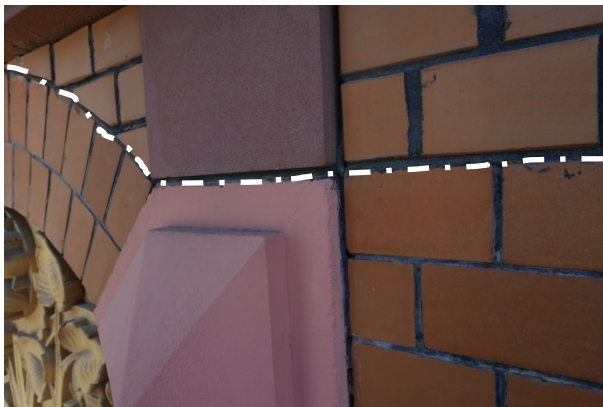
Figur 14: Detalj fra fasaden mot Universitetsgata mellom 4- og 5. etasje. Ovenfor stiplet linje er fasaden påbygget, og den røde sandsteinen og teglsteinmurverket er sekundære. Nedenfor stiplet linje er det original murverk med støpt steinimitasjon og dagens rosa oppmaling.
