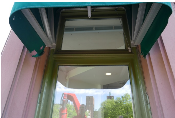
Figur 24: Tårn, 3. etg. mot Karl Johans gate. Vinduet er et moderne isolerglassvindu.
