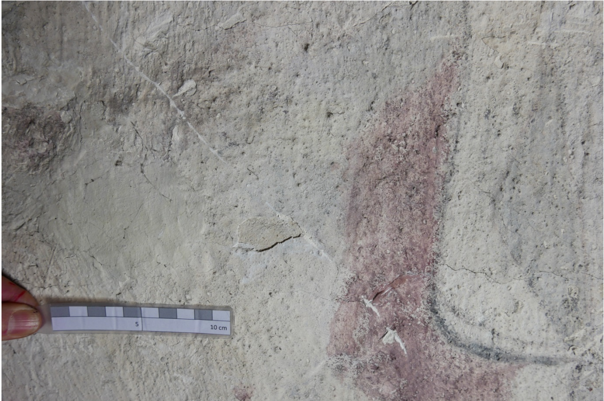
Figur 23: Detalj på sørvegg: Nyere mekanisk skade.
