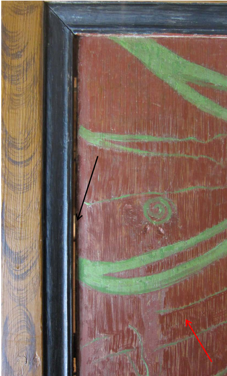
Fig. 7 Detalj midtre fyllingens øvre venstre hjørne. Fyllingen har krympet, slik at det er sprekk mellom ramme og fylling (svart pil). Rød overflate på fyllingene har hatt mange skader. Mesteparten av dagens synlige røde maling er retusjer (rød pil).
