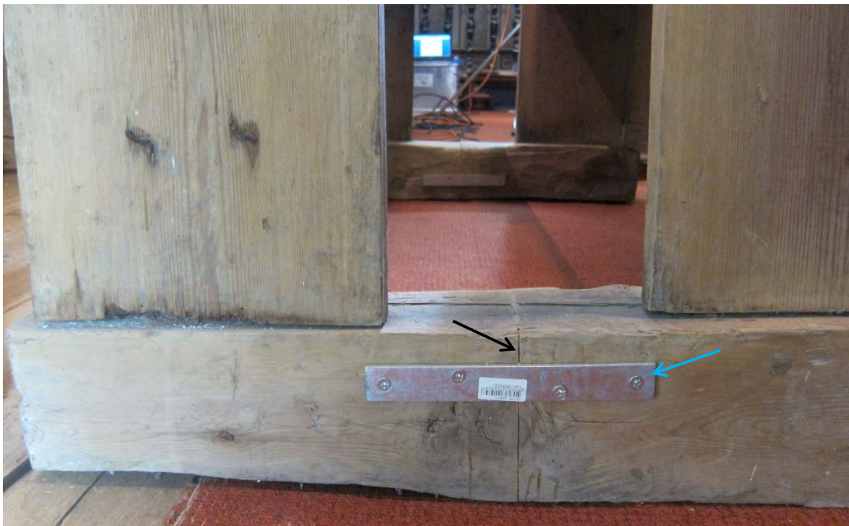
Fig. 9 Beina har blitt saget gjennom på et tidspunkt (svart pil). Stålbreslag ble montert på innsiden til senere sammenføring (blå pil).
