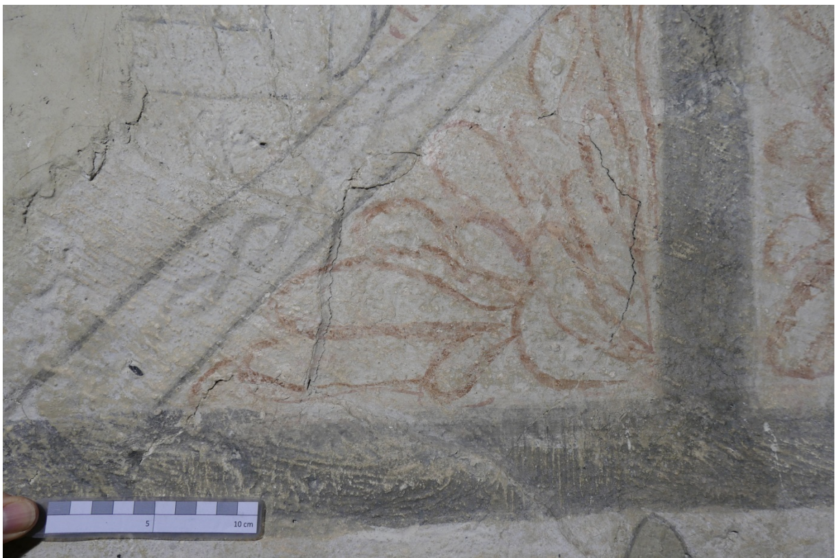
Figur 14: Detalj fra nordvegg. Sprekker i underlaget.
