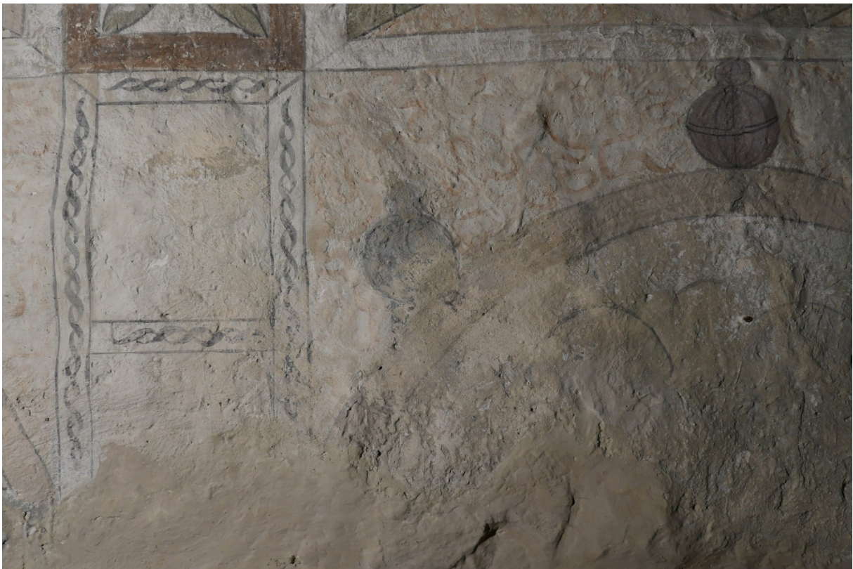
Figur 18: Detalj fra nordvegg, nedenfor galleriet. Område med løs maling og oppskallinger.
