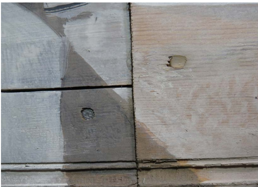
Figur 2 Felt 1, eksempel på moderne spiker i ny komplettering av trebord, kittet skruerull i lyst område til høyre
