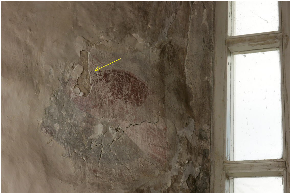
Figur 21: Detalj i vindussmyg ved østre vindu (bak alterskapet). Større pussutfall, sprekker og tilsynelatende løs puss/slemming (pil).
