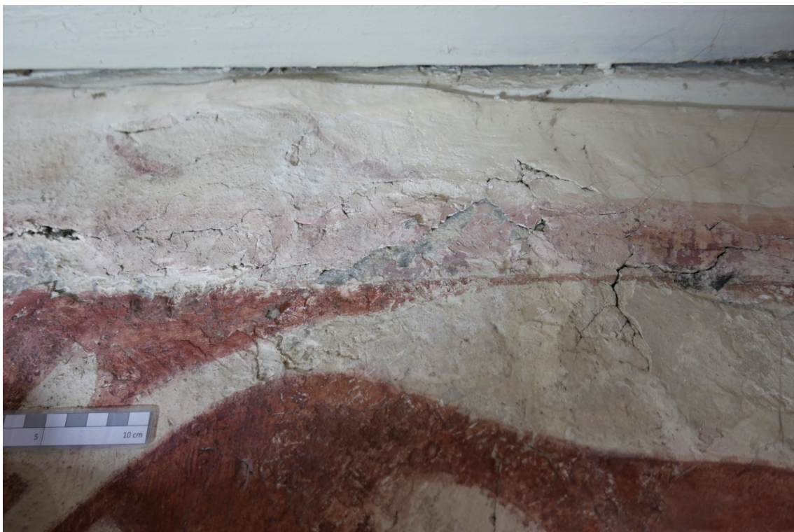
Figur 20: Detalj på sørvegg. Mange sprekker i underlaget nedenfor himlingen. Området har bom og meget løs puss.
