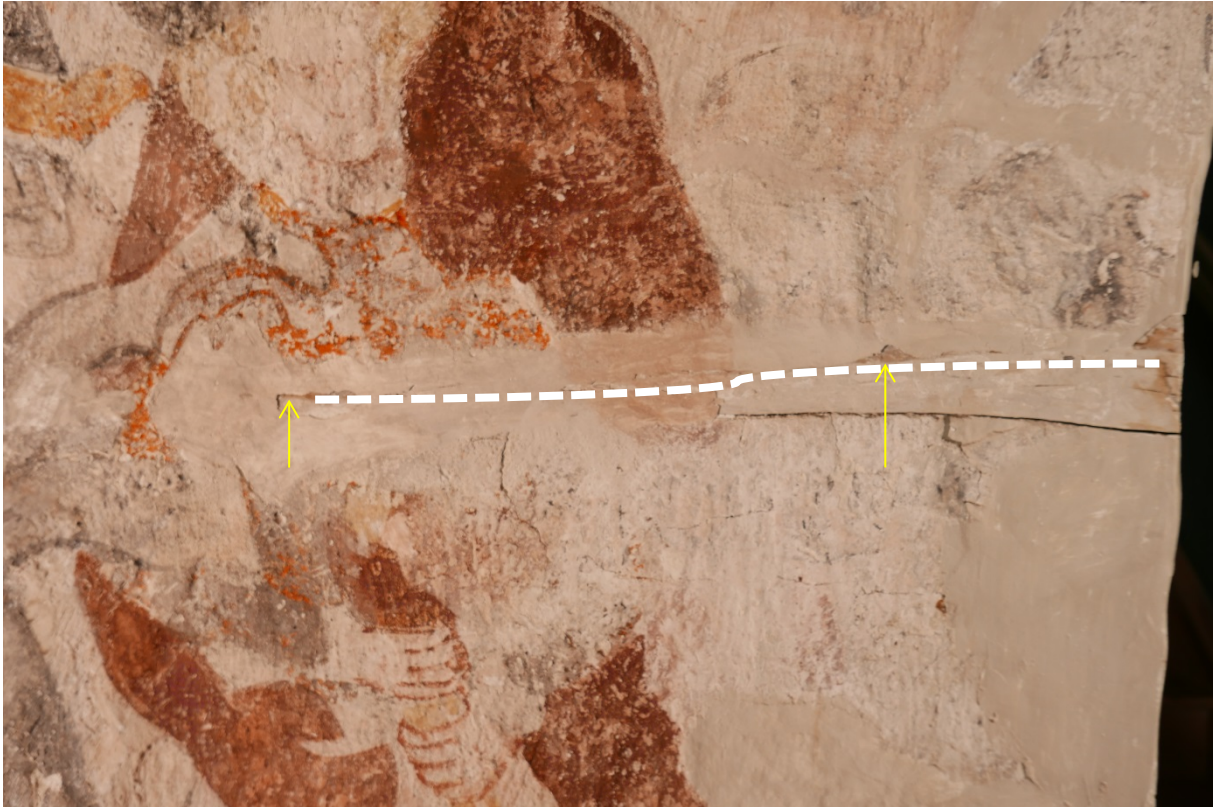
Figur 5: Detalj fra korbuen. En tømmerstokk er bygget inn i murlivet (stiplet linje), og pussen har stedvis gått tapt (piler).
