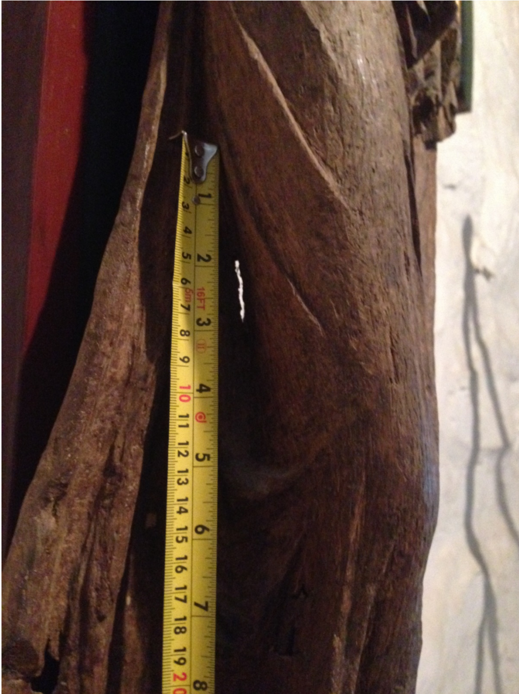
Figur 2 Sprekken i treverket mellom skulpturens lår og fritthengende lendelede måler 3 cm i lengden.
