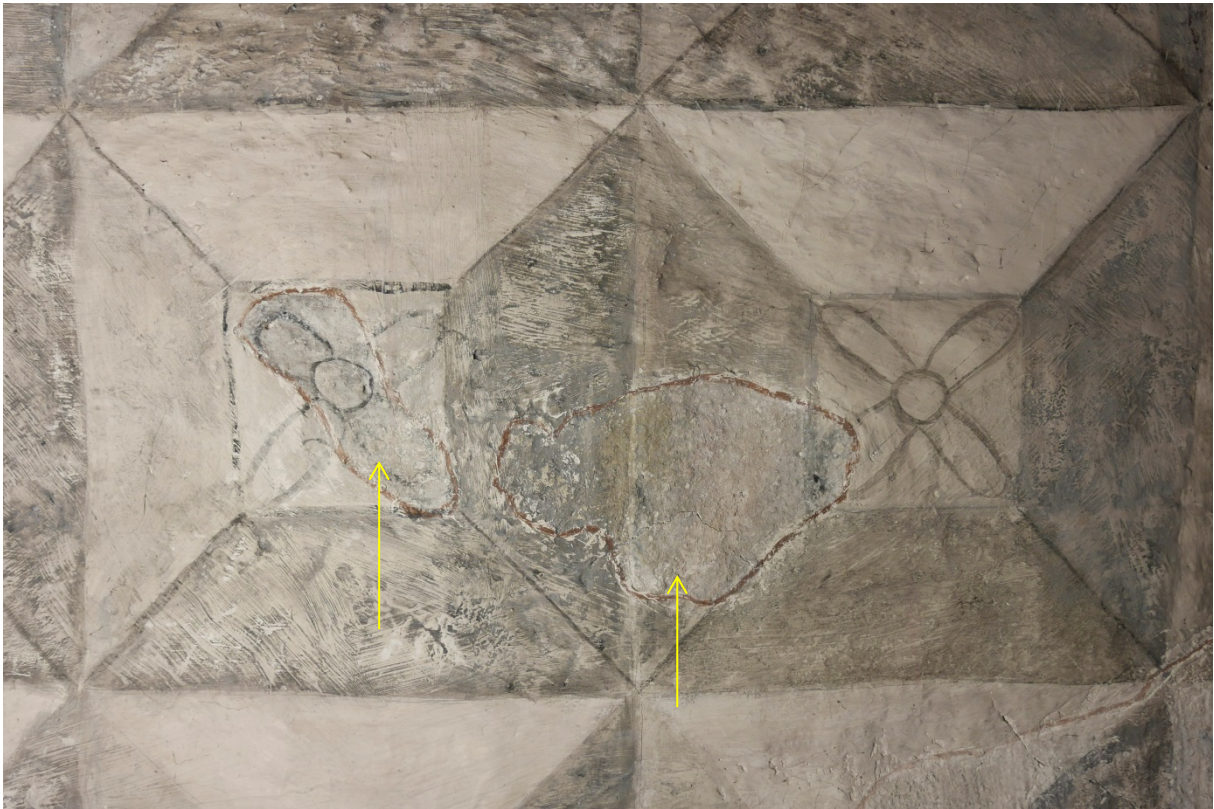
Figur 17: Detalj på sørveggen nedre del. Store områder i nedre veggdel er rekonstruert, og originale fragmenter er merket med en krum omramming (piler).
