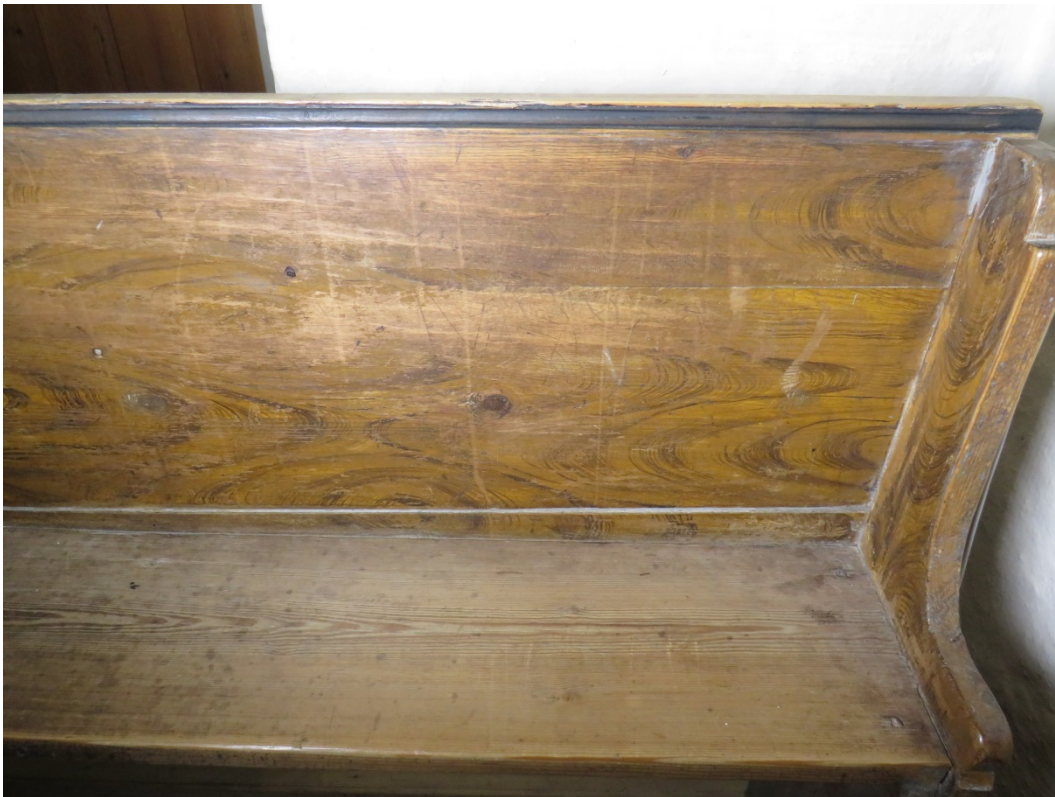
Figur 4 Klokkerbenkens sitteplass med bruksslitasje synlig.
