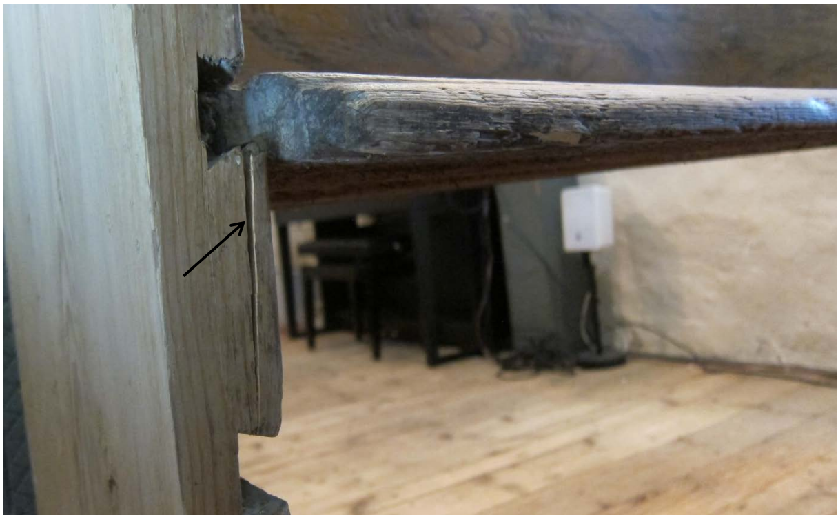
Figur 6 På venstre side er det sprekk i den planken som bærer sittebenken (svart pil).
