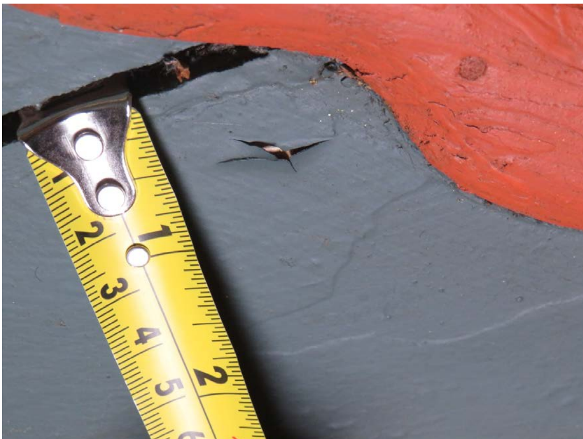
Figur 9 Eksempel på en av mange oppskallinger i malingslaget på dåpshimmelens underside.
