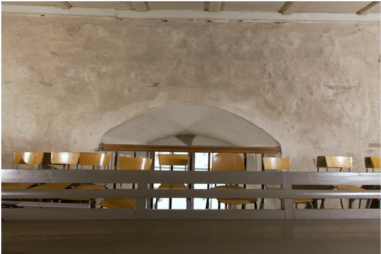
Figur 3: Kalkmaleri på nordvegg i skipet, midtre del på galleriet. Enkelte fragmenter med kalkmalerier er bevart.
