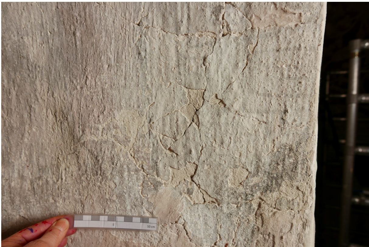
Figur 19: Detalj på vindusmyg ved søndre vindu. Nett av tynne sprekker i underlaget.
