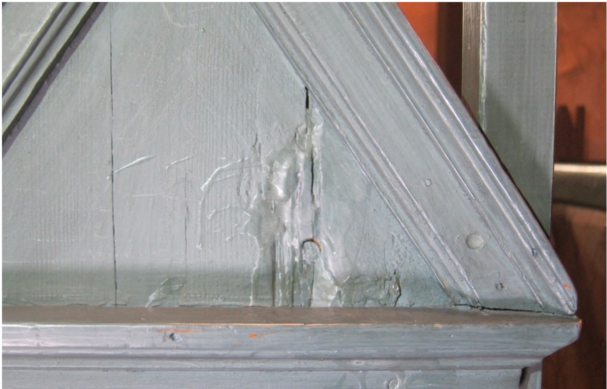
Fig 36 Detalj benkevange nr. 14 sør. Skader på forsiden etter at benkerygg er fra baksiden felt inn i benkevangen.
