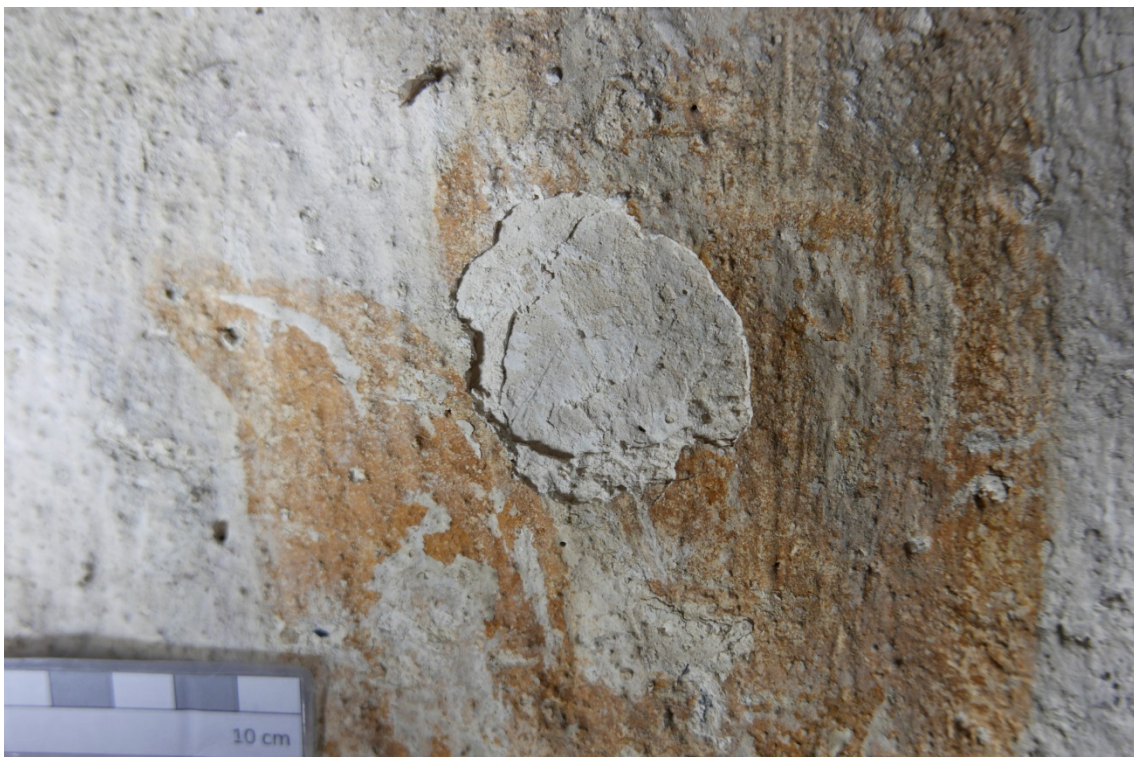
Figur 22: Detalj på sørvegg. Nyere skade i selmingslaget. Her kan man se overflaten til et underliggende slemmingslag.
