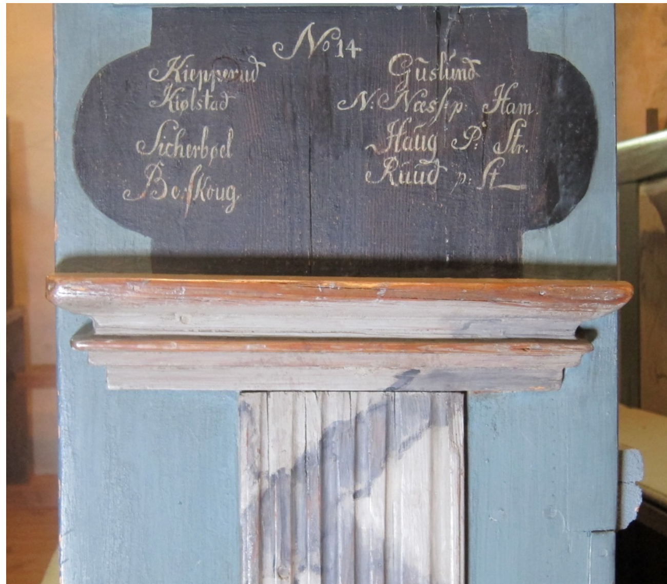
Figur 32 Detalj benkevange nr. 14 sør. Eksempelbilde på sprekker i treverk. Sett inn piler
