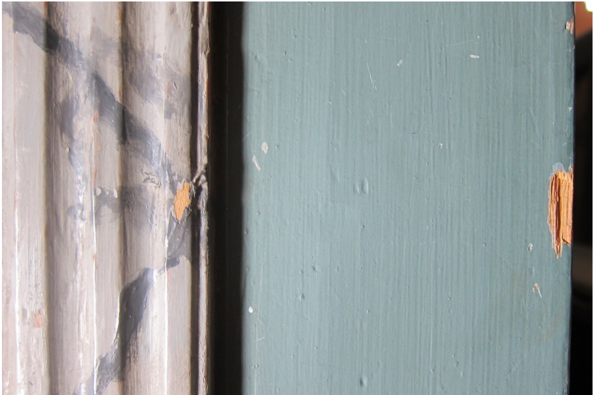
Fig 37 Detalj benkevange nr. 11 nord. Skader i treverk.
