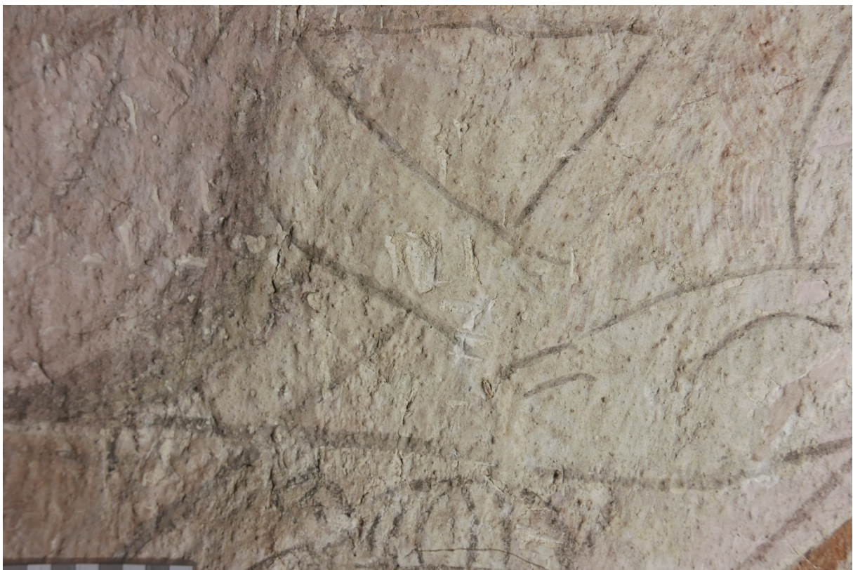
Figur 16: detalj på sørvegg. Hakk i slemmingslaget etter avdekkingen.
