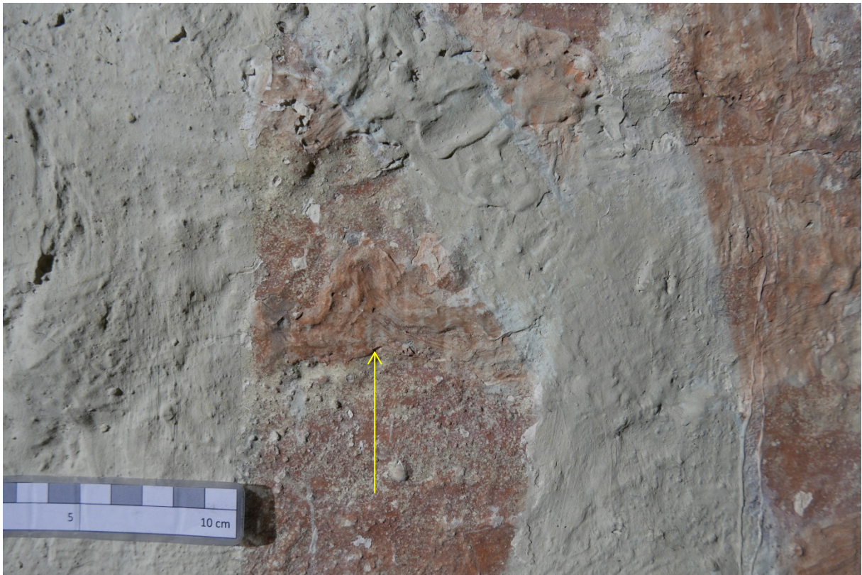
Figur 21: Detalj fra nordvegg, nedenfor galleriet. En tidligere kitting er retusjert med rød lasur (pil).
