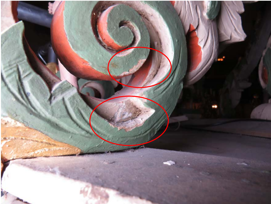
Figur 8 Eksempel på mekaniske skader på volutter som har ført til avskallinger i malingslaget.
