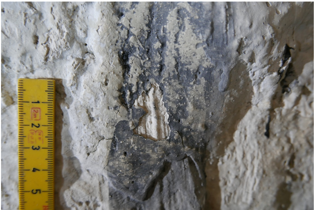
Figur 13: Detalj fra sørvegg. Skade i slemmingslaget.
