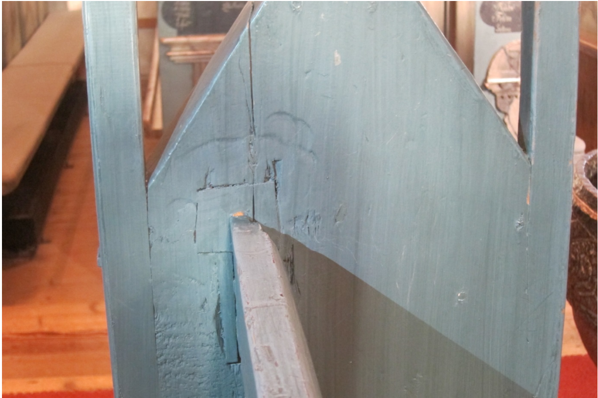
Fig 35 Detalj benkevange nr. 14 sør. Skader på baksiden etter at benkerygg er felt inn i benkevangen.
