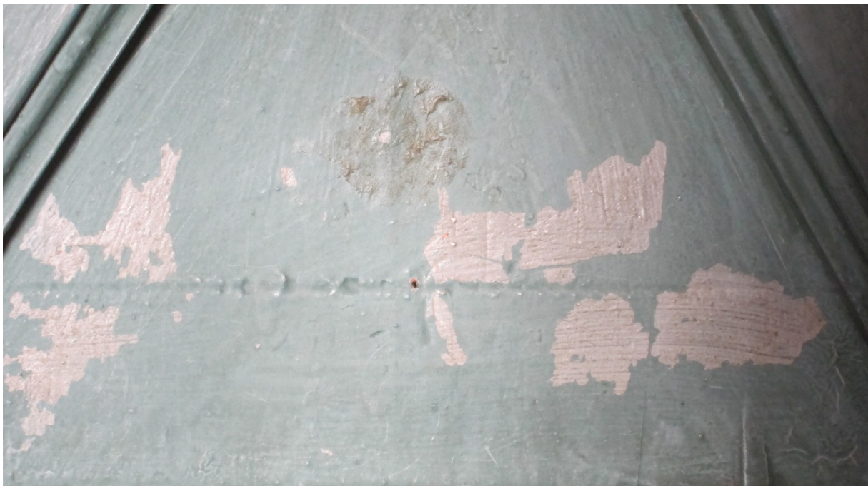
Fig 40 Detalj benkevange nr. 2 sør. Avskallinger i gavfelt viser underliggende maling.
