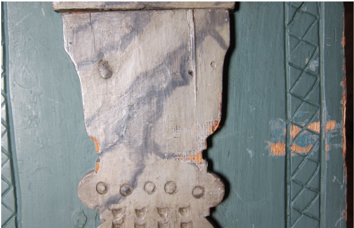
Fig 38 Detalj benkevange nr. 1 nord. Skader i treverk. Spesielt sidekantene hadde mange slike skader.
