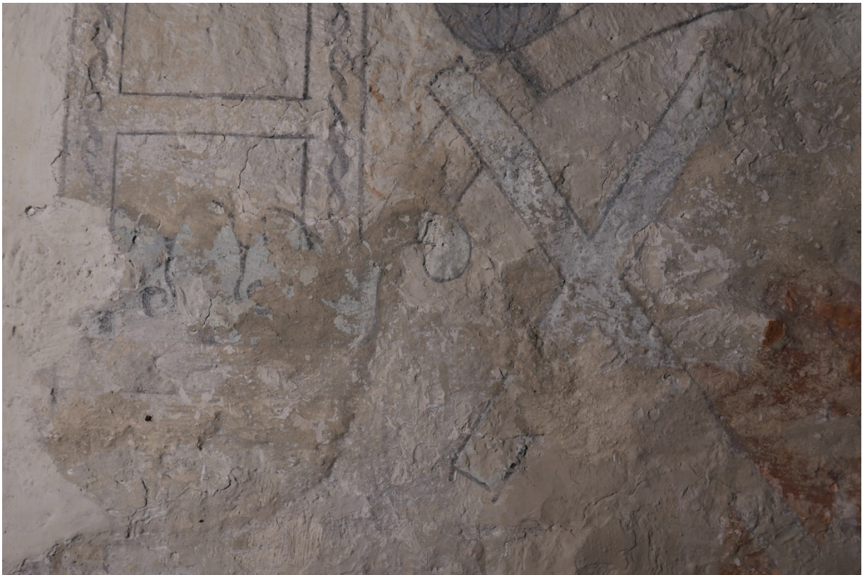
Figur 17: Detalj fra nordvegg, nedenfor galleriet. Område med løs maling og oppskallinger.
