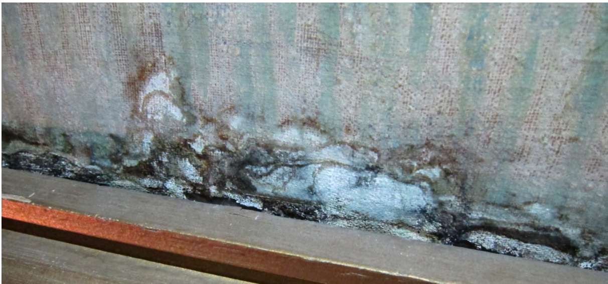
Figur 14. Vannskjolder i nedre kant med mulig nedbrytning i lerret, maleri nr. 8.
