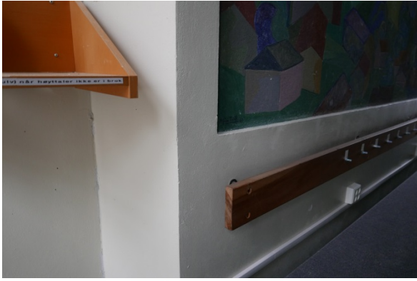
Figur 4: Veggmaleriet er plassert på en utspring, og selve veggmaleriet ligger dypere enn den omrammende veggoverflaten. Foto: NIKU 2017
