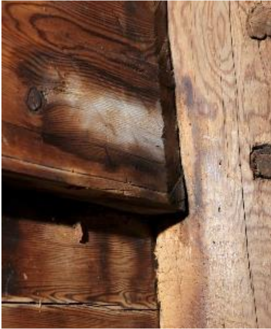
Figur 2. Detalj fra figur 1 som viser områder med indikasjoner på biologisk/kjemisk skade: lyse/hvite områder i treet med mørkere skjolder rundt. Foto: Riksantikvaren.
