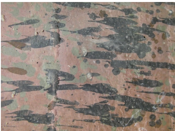
Figur 6 Detalj fra overflaten.
