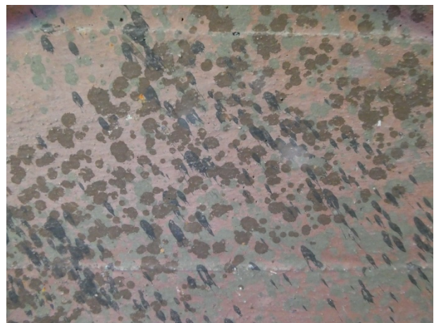
Figur 7 Detalj fra overflaten.
