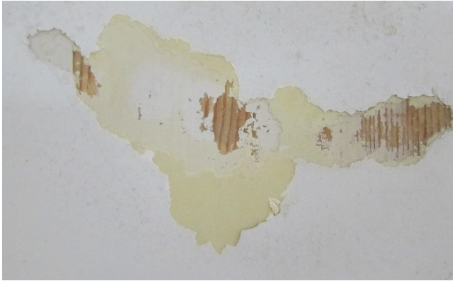
Figur 1: Opprinnelig maling som har stått lenge udekket og eksponert for lys på en dør i 3. etasje (utsiden av ytre dør korridor/rom 310).
