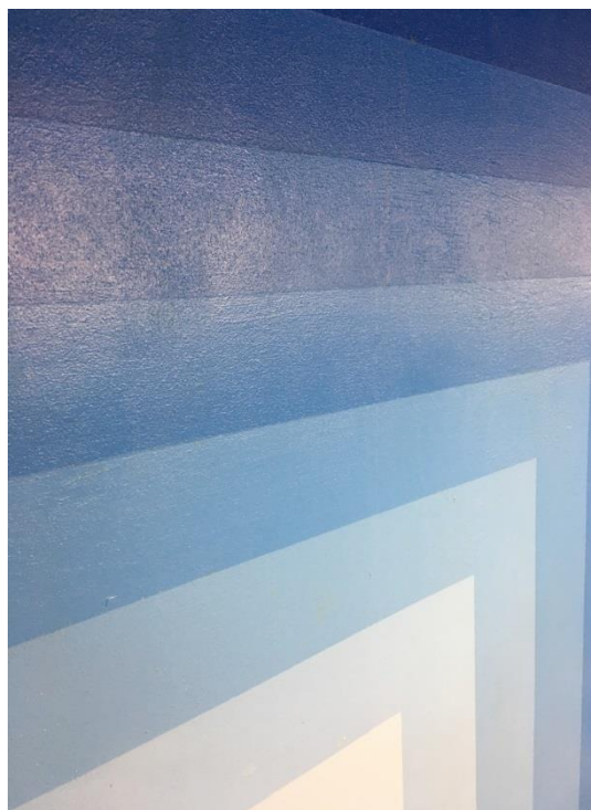
Fig. 17 Rennemerke i venstre kvadrat, 1. etg- Etter behandling
