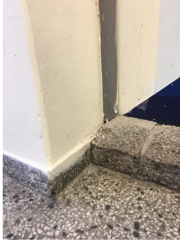
Fig. 13 2. etasje: rester av original terrazzolist til venstre
