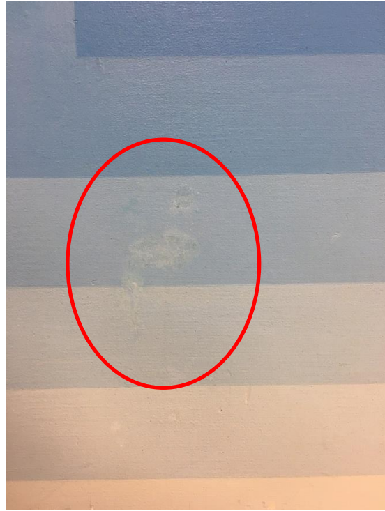
Fig. 8 1 etg.: Skader der malingen delvis var fjernet og gnidd utover. Grønnlig skjær på blåfargen i skadeområde
