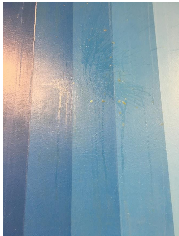
Fig. 15 Søl på overflaten etter noe som har blitt kastet mot veggen
