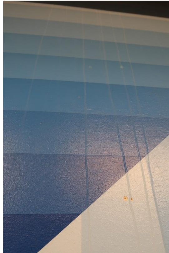
Fig. 11 2. etg. Rennemerker i øvre del
