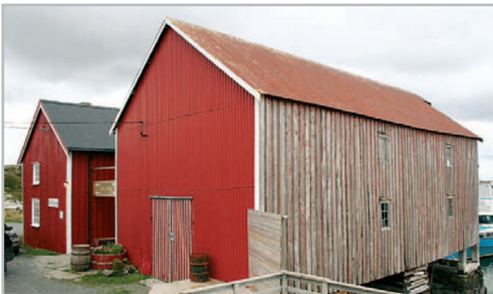
Figur 8. Vegstein. Storbrygga. Østveggen står fremdeles med rester av tranmalingen som ble påført i 1955-56. Foto J. Brønne. 2005.
