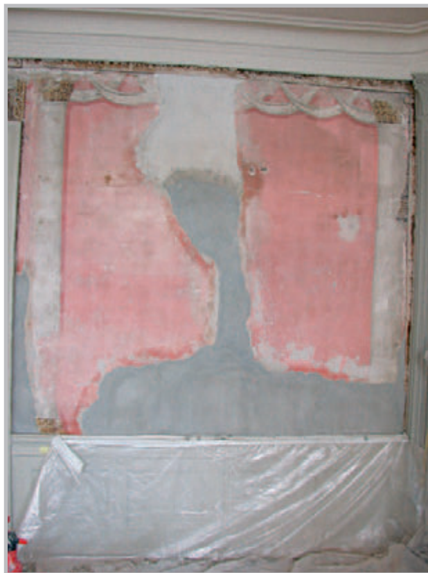
Figur 1. Veggfelt med muralmalerier utført på tørr puss fra 1801-05, Kjørbo gård i Bærum, Akershus. Bildet er fra restaureringsarbeider i 2000 og viser hvordan skadde områder i puss ble kalkpusset på nytt før konsolidering og restaurering av malingen. Foto B. Heggenhougen, NIKU 2000.
