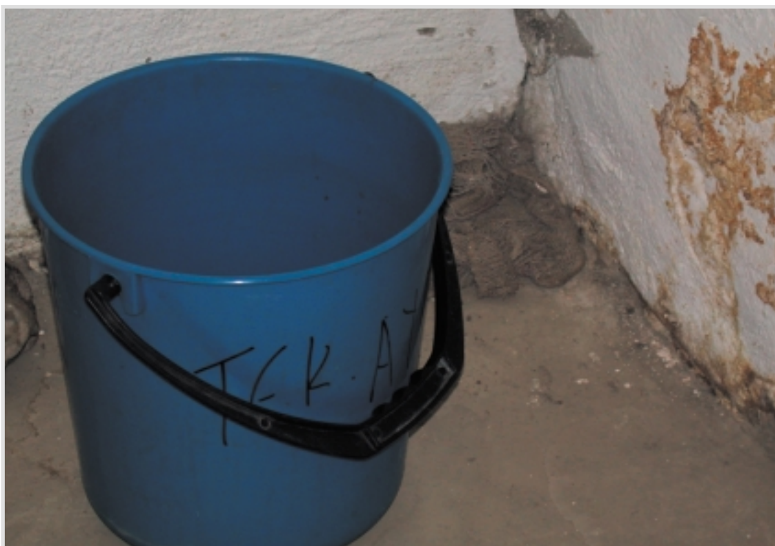
Foto 1 Fuktinnsig i fjernlager ved UKM
