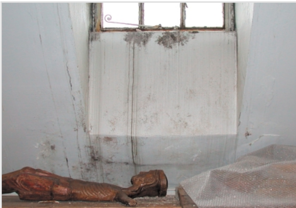
Foto 14 Lite gunstige lysforhold for måla gjenstandar og fuktskadar under vindaug i dette magasinet ved BM-K.
