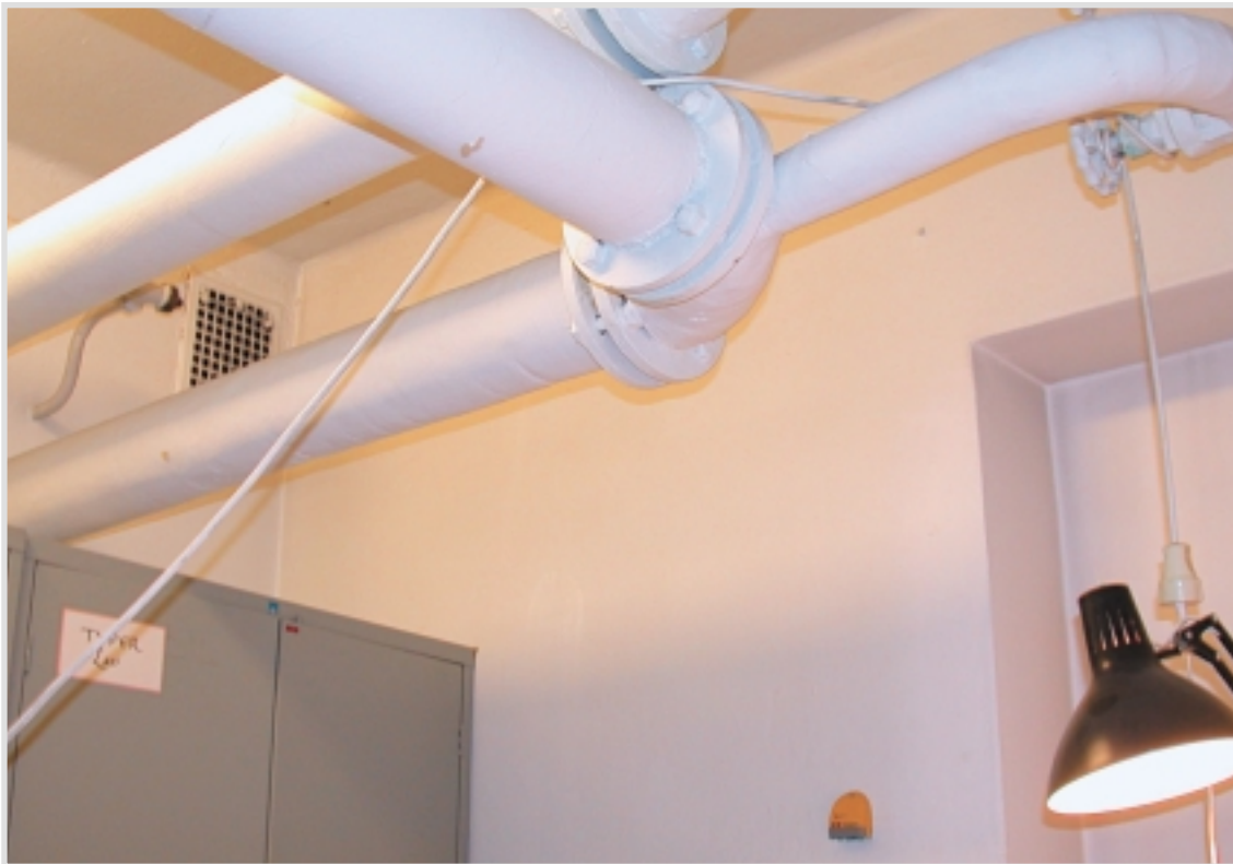
Foto 12 Lave, vassførande rør gjør at denne eininga ved NHM ikkje er eigna som magasin.
