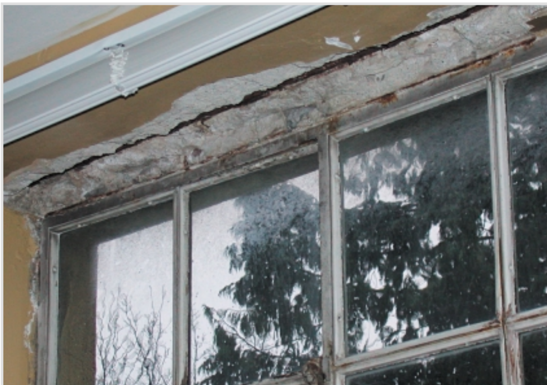
Foto 13 Manglande vedlikehold av vindaug i utstillingslokale ved BM-K.
