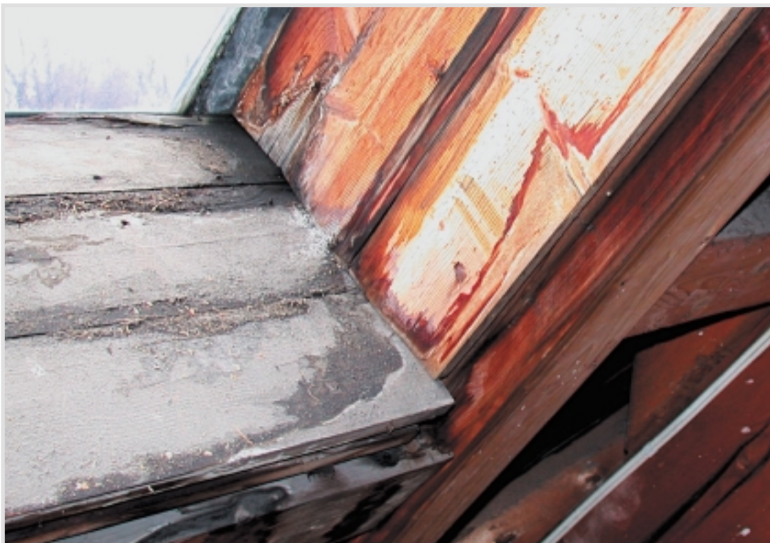
Foto 6 Uakseptabelt vedlikehald av lekkasjepunkt i takvindaug på loft ved Botanisk museum, NHM.
