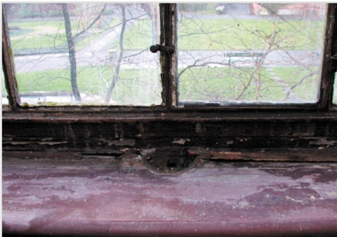
Foto 19 Vindauga i ei eining ved BM-N ber tydeleg preg av manglande vedlikehald.
