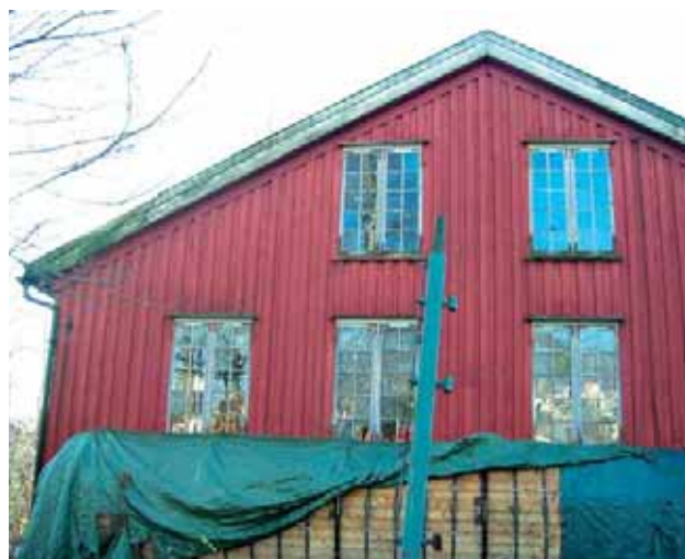
Figur 43. Klokkebodens østre gavl med gamle sekundært anvendte vindusrammer. Foto NIKU 2006.
