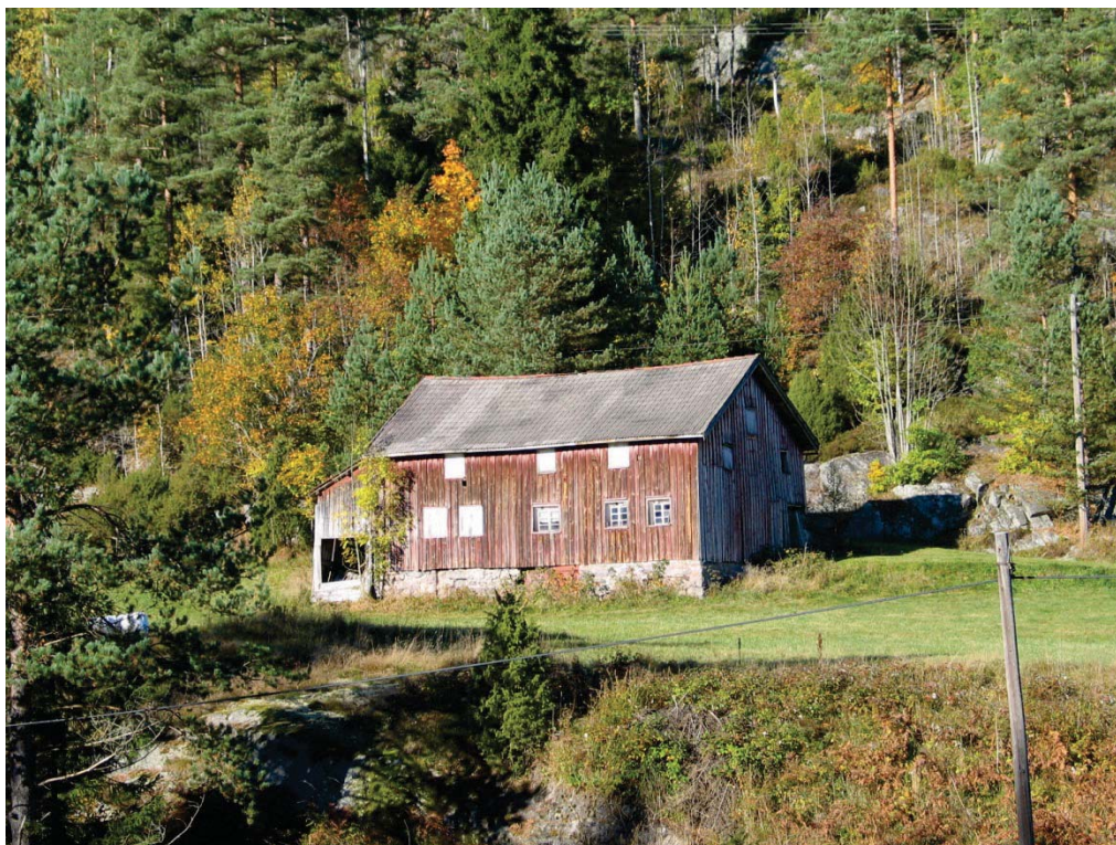
09110105017: Det var gjennomsnittlig dårligere bygningstilstand i de tettbygde strøkene enn de spredte områdene i Gjerstad både i 2. og 3. omdrev. Mens forholdene var dårligst i Gjerstad tettsted i 2. omdrev, var det de tettbygde kretsene ved E18 som falt dårligst ut i 3. omdrev. Denne driftsbygningen var intakt i 2005. Foto: Kulturminnekompaniet 2005.
