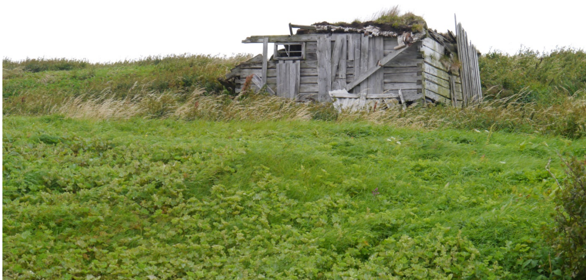
18150111065: Ni bygninger er registrert som tapt i 3. omdrev av kontrollregistreringen i Vega kommune. Tre av de tapte bygningene har falt i ruin. For de øvrige seks er tapsårsaken ukjent. Foto: KF/NIKU 2013
